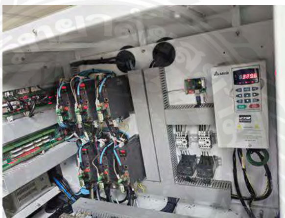
รูปที่ 2.4 ตู้ไฟฟ้าสำหรับระบบคอนโทรล
