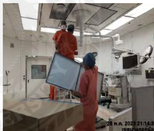
รูปภาคผนวก ที่ 4 เปลี่ยน Filter Medium ภายในห้อง
