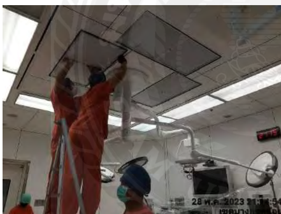
รูปภาคผนวก ที่ 3 ถอดเช็ค Filter Medium ภายในห้อง
