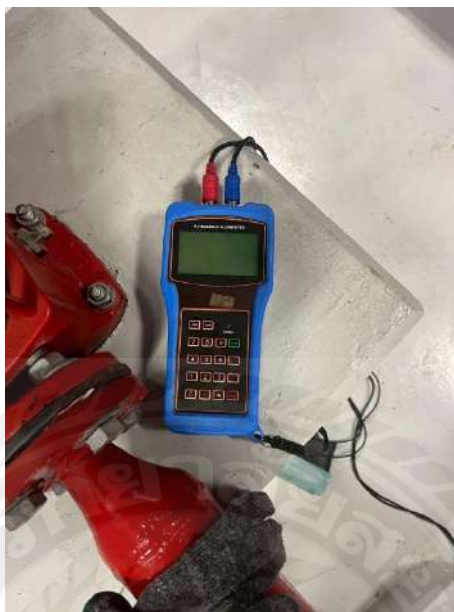
รูปที่ 3.9.3.3 เครื่องจับอัตราการไหล (Flow Meter)
