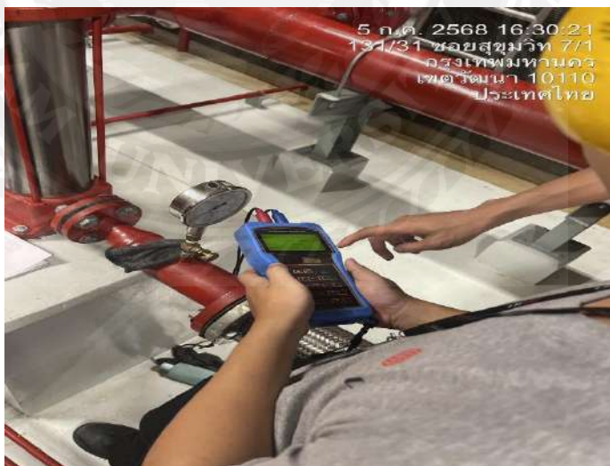
รูปที่ 3.10.8 บันทึกข้อมูลที่ได้จากเครื่อง Flow test
