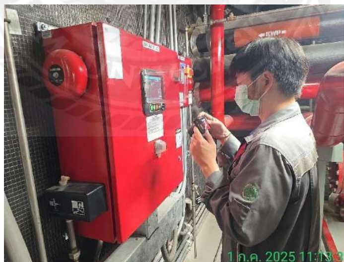
รูปที่ 3.10.10 ปิด OFF ที่หน้าตู้คอนโทรล
