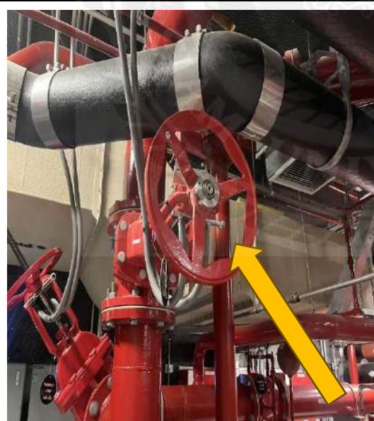
รูปภาคผนวก ที่ 11 วาล์ว Supply test flow
