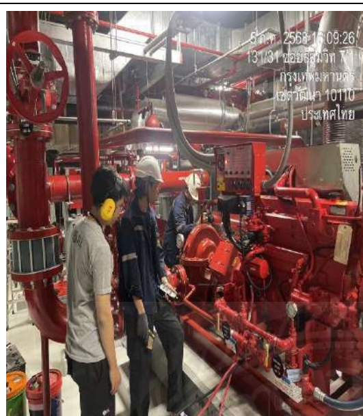
รูปภาคผนวก ที่ 21 ทดสอบหน้าเครื่อง fire pump
