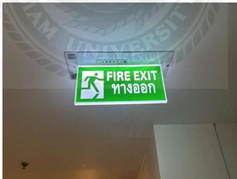
รูปที่ 3.11 ป้ายบอกทางออกฉุกเฉิน
