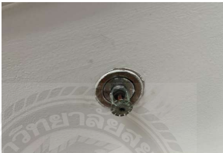
รูปที่ 3.32 หัวสปริงเกอร์ดับเพลิง
