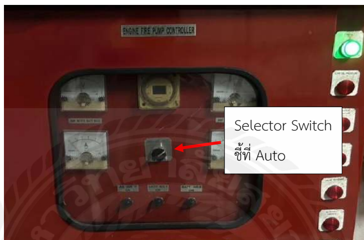
รูปที่ 3.28 Selector Switch แบบ Automatic
