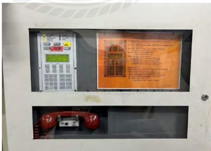
รูปที่ 3.33 ตู้คอนโทรล Fire Alarm Control Panel
