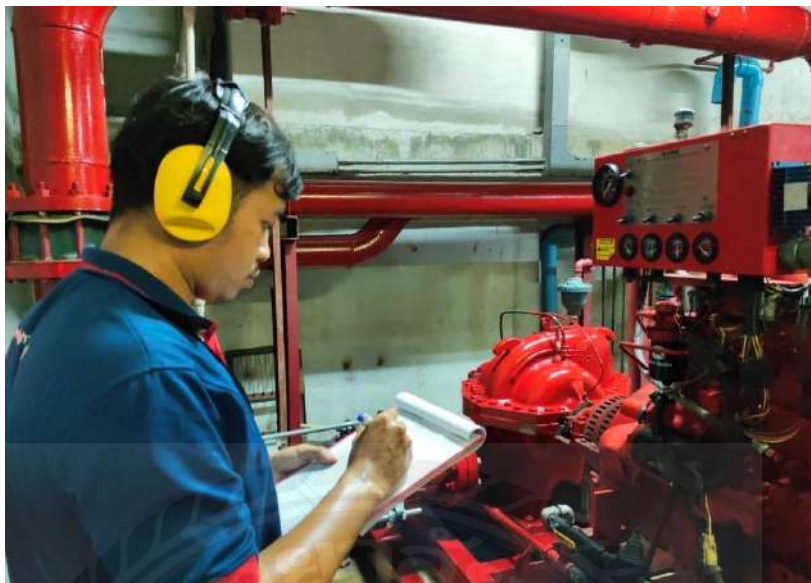
รูปที่ 3.22 การทดสอบ Fire Pump ประจำสัปดาห์
