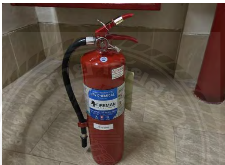
รูปที่ 3.30 ถังดับเพลิง
