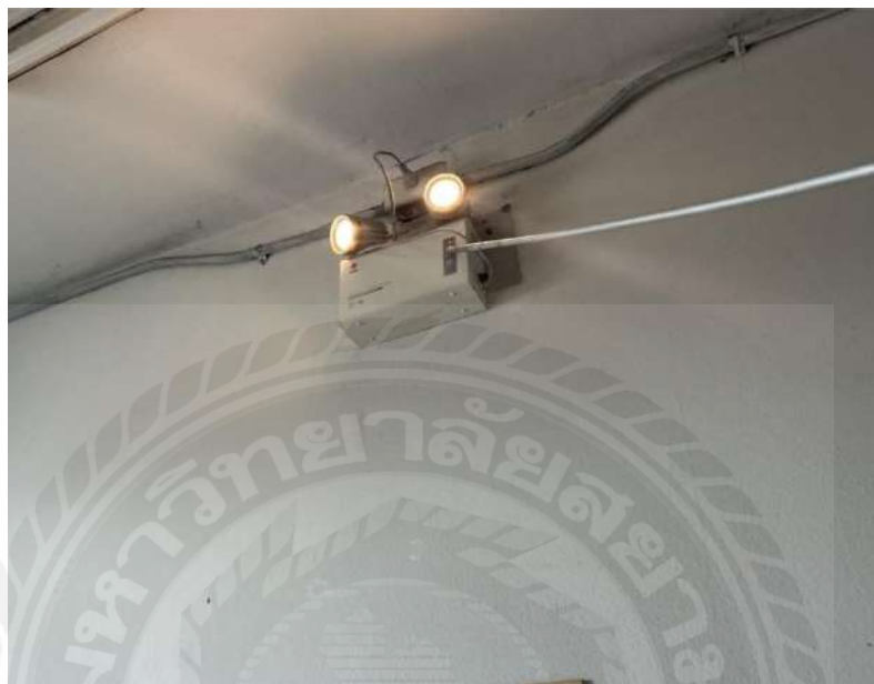
รูปที่ 3.10 ตรวจสอบเช็คการทำงานของไฟ Emergency Light
