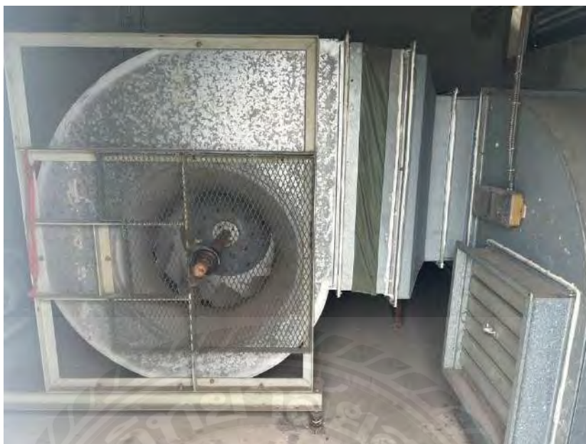
รูปที่ 3.16 พัดลมอัดอากาศทางหนีไฟ (Pressurization Fan)
