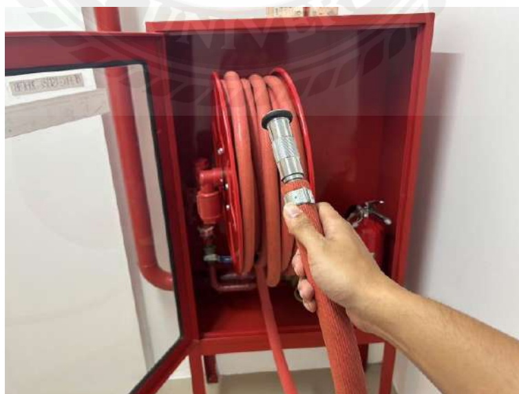
รูปที่ 3.29 ตู้ดับเพลิง Fire Hose Cabinet
