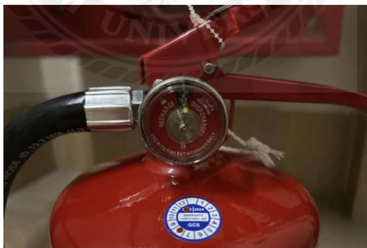
รูปที่ 3.31 เข็มวัดแรงดันภายในถังดับเพลิงสถานะแถบสีเขียว
