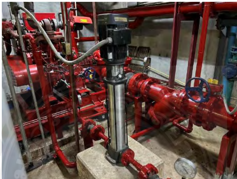
รูปที่ 3.24 ปั๊มรักษาแรงดันน้ำดับเพลิง Jockey Pump
