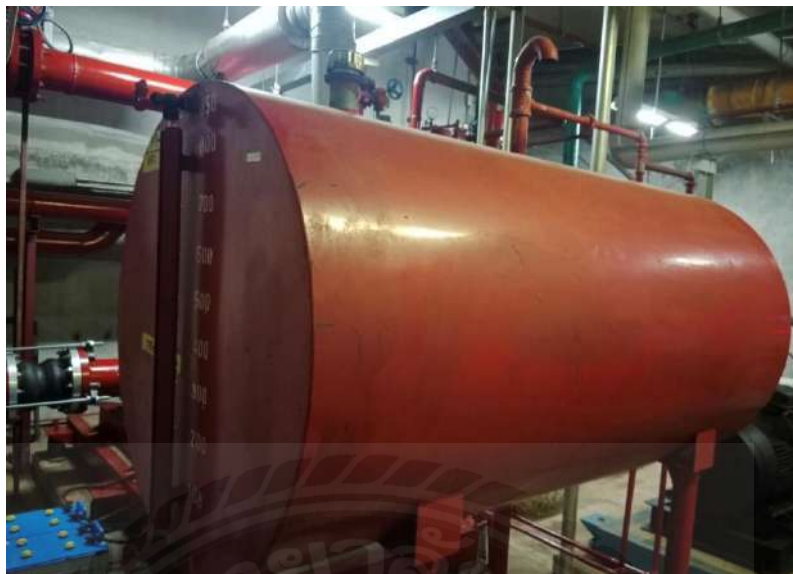
รูปที่ 3.19 Oil Tank เครื่องสูบน้ำดับเพลิง
