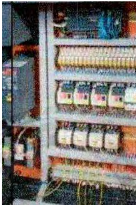
รูปที่ 2.8 แผงไฟฟ้าควบคุมเครื่องจักร
