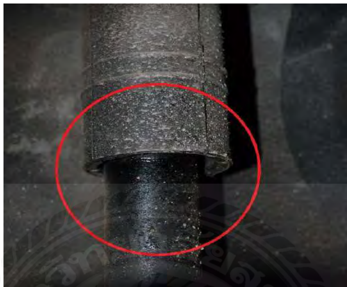
รูปที่ 2.10 คราบน้ำมันเกาะที่กระบอกใช้คอล์ยหรือไหลไปตามแกนใช้คอล์ย
