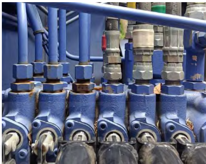
รูปที่ 3.16 การตรวจสอบการรั่วซึมระบบไฮดรอลิก (Hydraulic)
