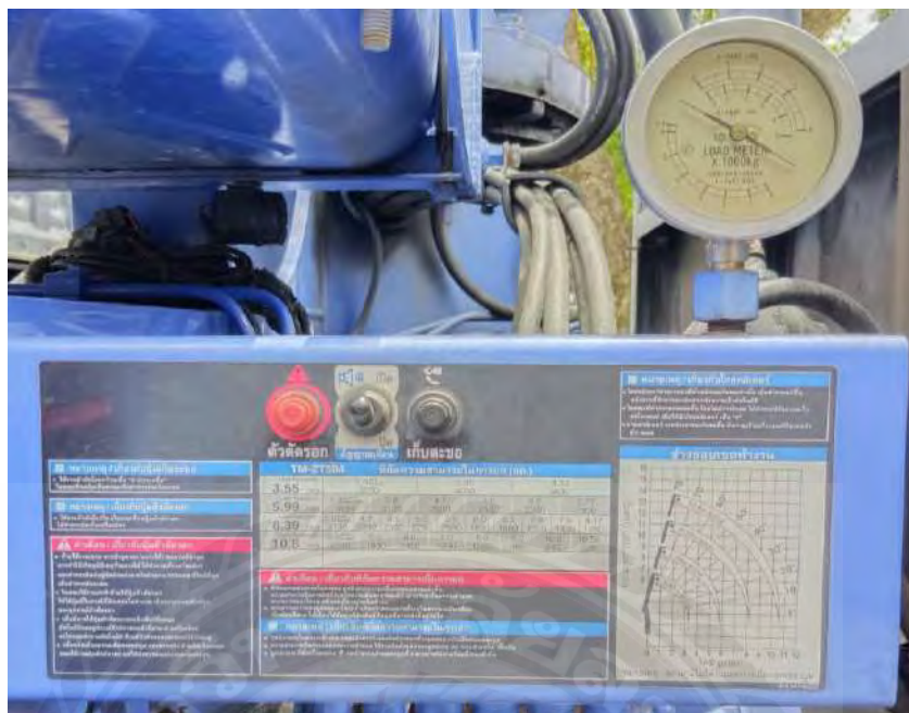
รูปที่ 3.18 การตรวจสอบการทำงานของชุดควบคุมพิกัดน้ำหนักรถ
