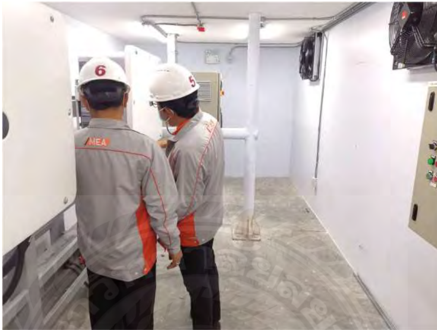
ภาพที่ 3.22 เจ้าหน้าที่จากการไฟฟ้านครหลวง (MEA) กำลังตรวจสอบและทดสอบการทำงานของอินเวอร์เตอร์ในห้องควบคุมระบบไฟฟ้า
