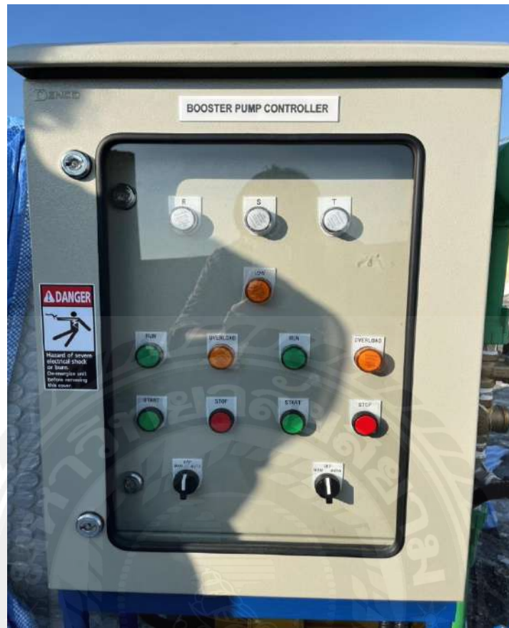
รูปที่ 3.30 ตู้ Booster Pump Controller
