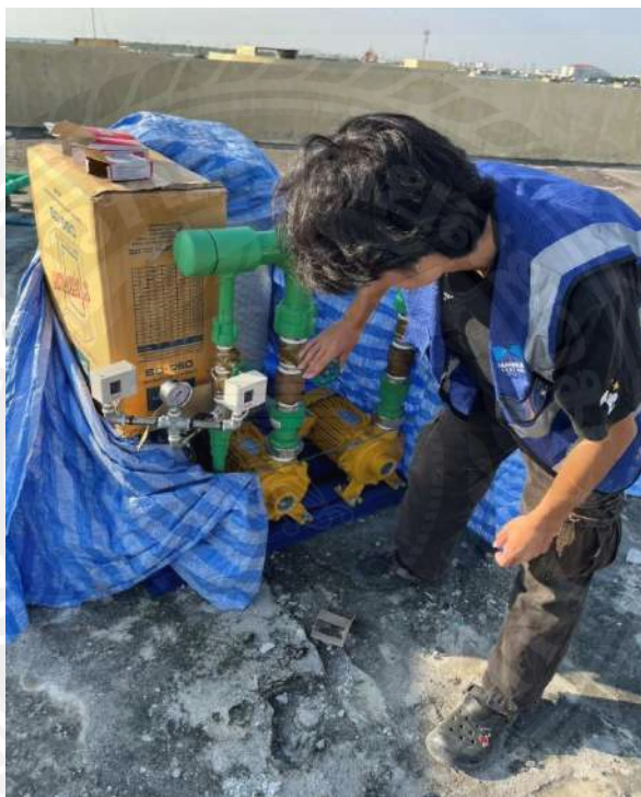
รูปที่ 3.26 ตรวจสอบ Booster Pump
