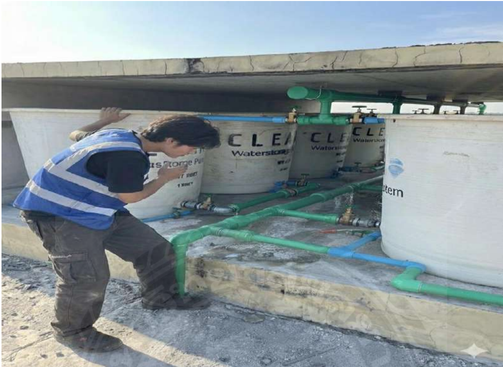
รูปภาพผนวกที่ 5 การตรวจสอบการรั่วซึมของท่อน้ำ
