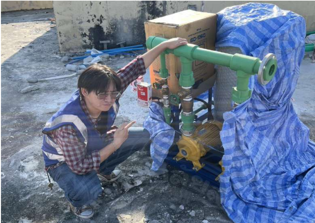
รูปภาพผนวกที่ 3 การตรวจสอบสภาพภายนอกของปั๊มก่อนการติดตั้ง
