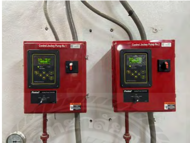
รูปที่ 3.24 ตู้ควบคุมของ Jockey Pump
