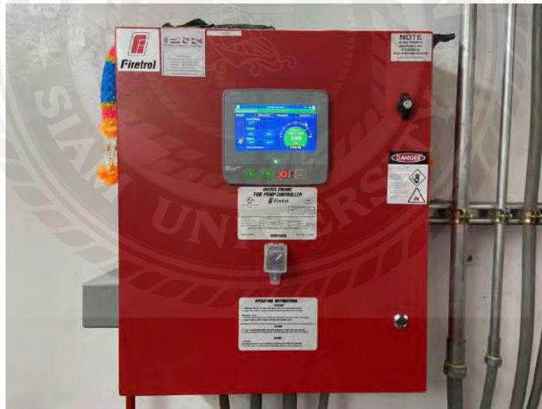
รูปที่ 3.25 ตู้ควบคุมเครื่องสูบน้ำดับเพลิง
