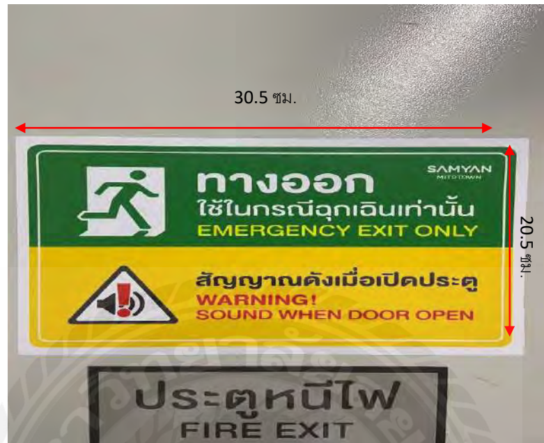
รูปที่ 3.18 ขนาดป้ายบอกทางหนีไฟความกว้าง 20.5 ซม. และ ยาว 30.5 ซม.
