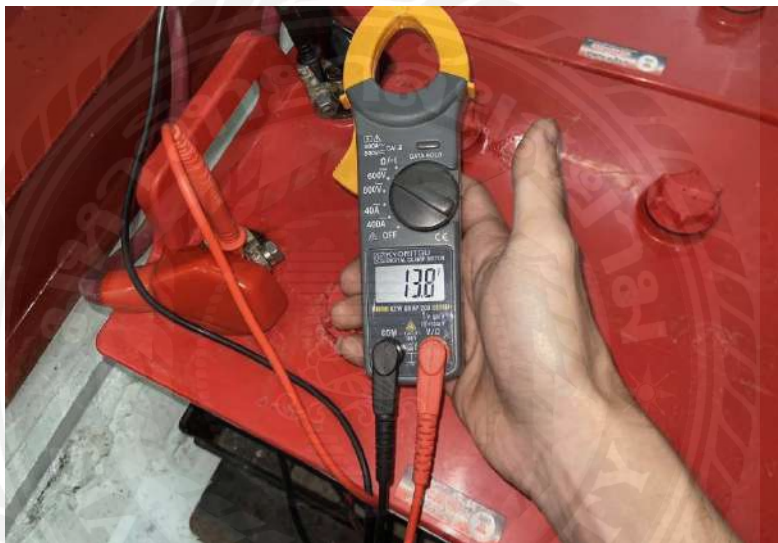
รูปที่ 3.23 แบตเตอรี่เครื่องสูบน้ำดับเพลิง
