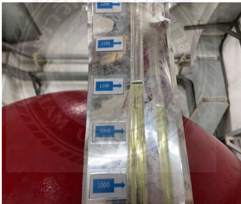
รูปที่ 3.20 การอ่านค่าระดับน้ำมันของ Oil Tank
