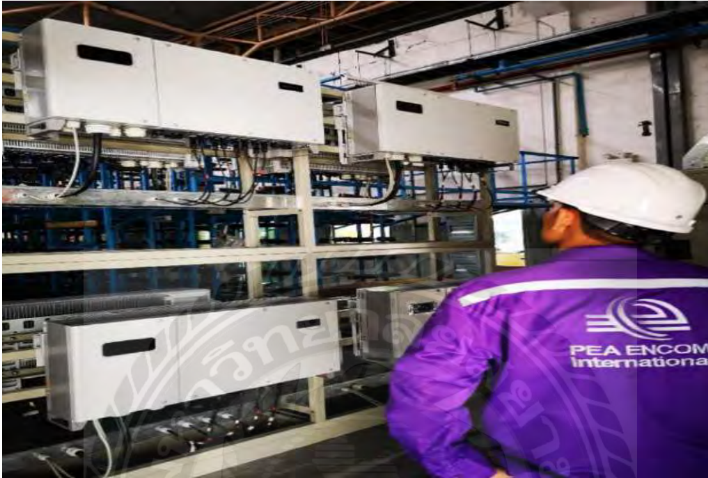
รูปที่ 4.14 ห้อง INVERTER ROOM
