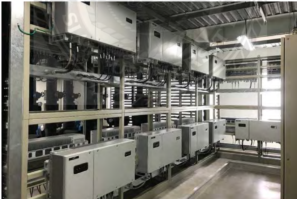
รูปที่ 4.15 ห้อง INVERTER ROOM
