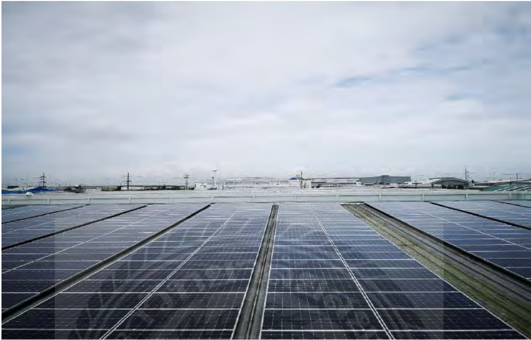
รูปที่ 4.18 SOLAR ROOFTOP SYSTEM
