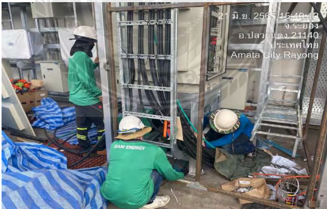
รูปที่ ค 14 AC Cable Wiring
