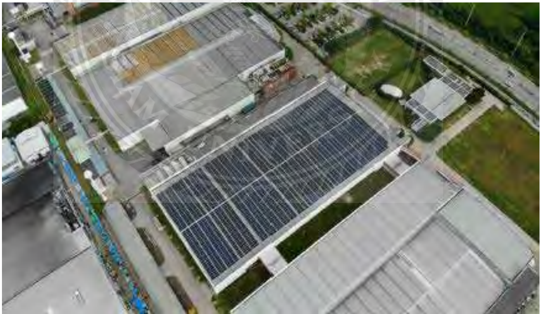
รูปที่ 4.19 SOLAR ROOFTOP SYSTEM
