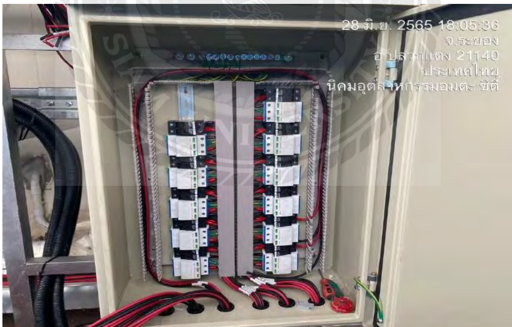
รูปที่ 4.11 การติดตั้งสายไฟเข้าสู่ตู้ควบคุม
