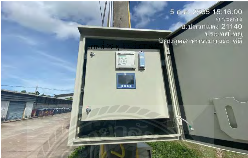
รูปที่ ค 29 อุปกรณ์ CT &amp; VT
