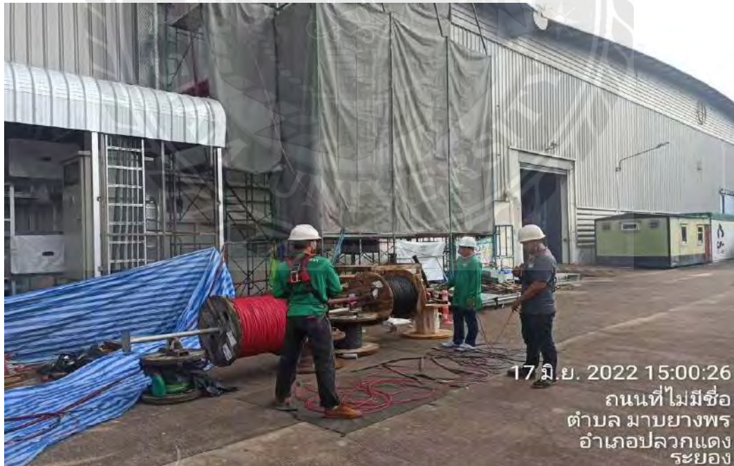
รูปที่ ค 12 สาย DC Cable Wiring
