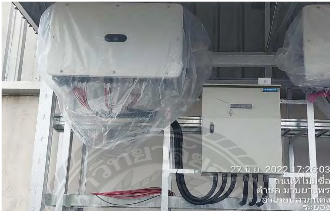
รูปที่ 4.10 ติดตั้งอินเวอร์เตอร์และตัวแปลงไฟฟ้า
