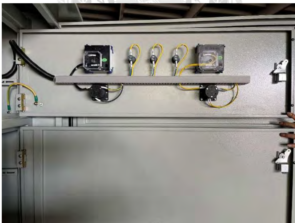
รูปที่ 4.14 ตู้ MDB 800A เดินสายไฟอุปกรณ์วัดค่าทางไฟฟ้า
