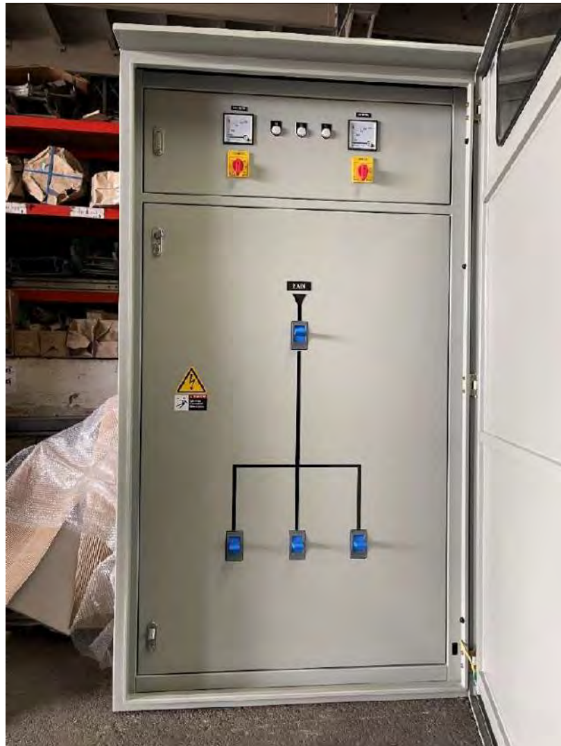
รูปที่ 4.10 ตู้ MDB 800A ฝาชั้นใน ด้านหน้า
