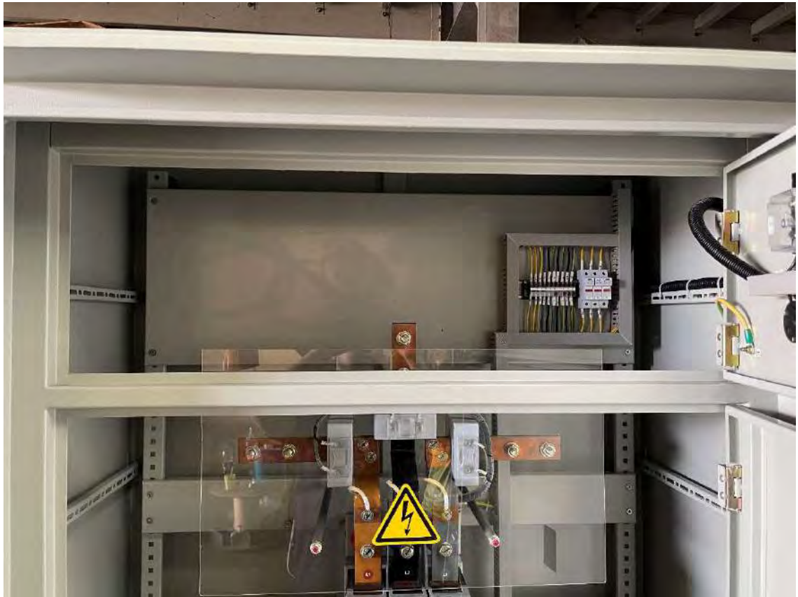
รูปที่ 4.15 ตู้ MDB 800A ฟิวส์ป้องกันอุปกรณ์วัดค่าทางไฟฟ้า
