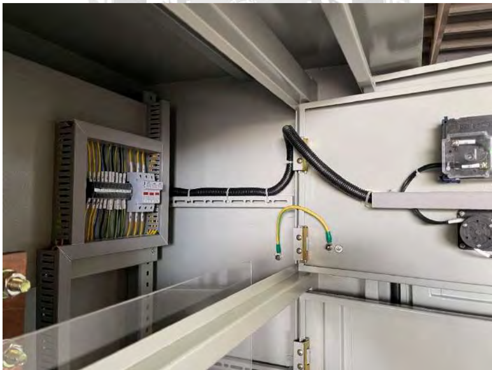
รูปที่ 4.22 ตู้ MDB 800A สายต่อฝากฝาคู่ชั้นใน ฝาด้านบน
