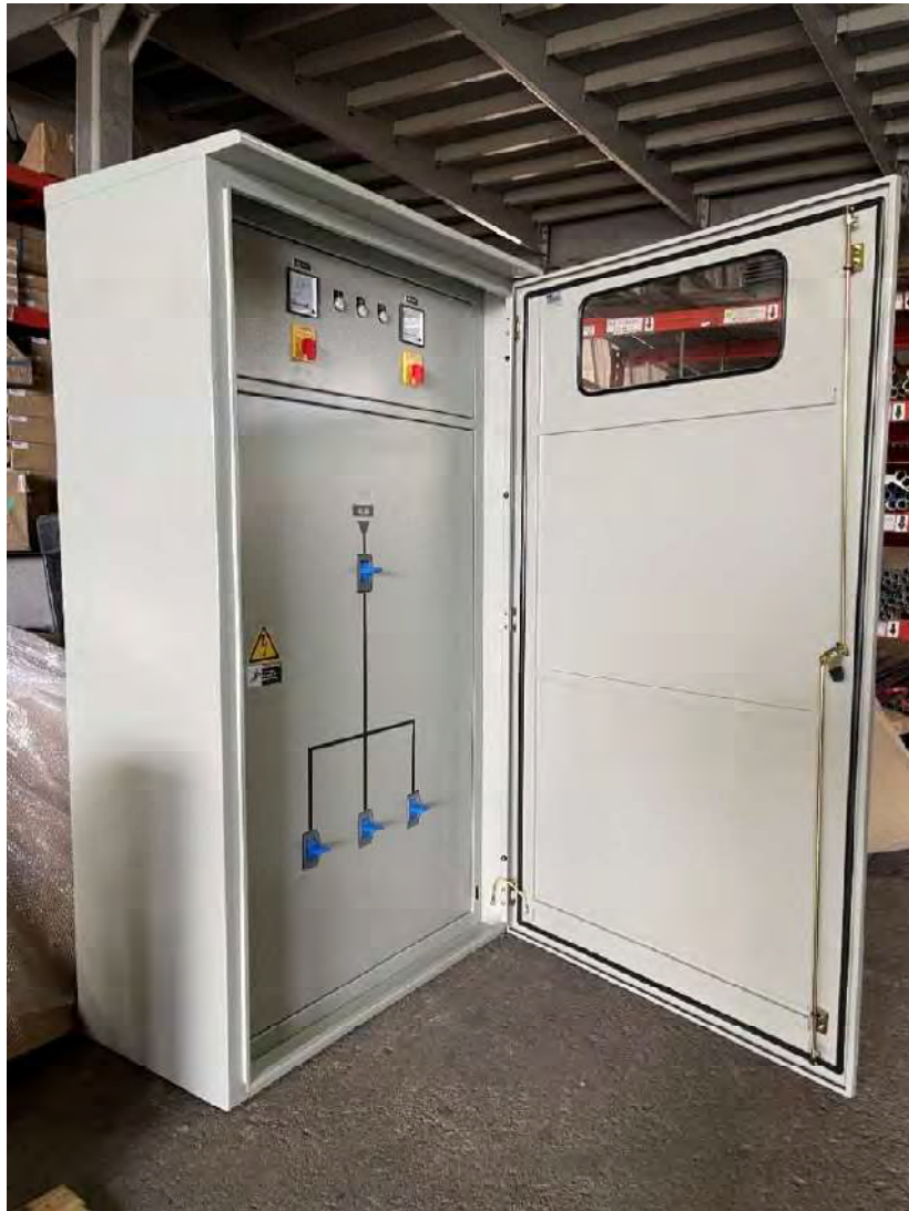
รูปที่ 4.12 ตู้ MDB 800A ฝาชั้นใน ด้านข้าง
