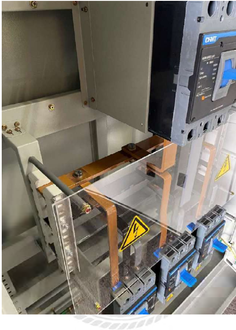
รูปที่ 4.19 ตู้ MDB 800A ติดตั้งบัสบาร์ทองแดง และฉนวนบัสบาร์
