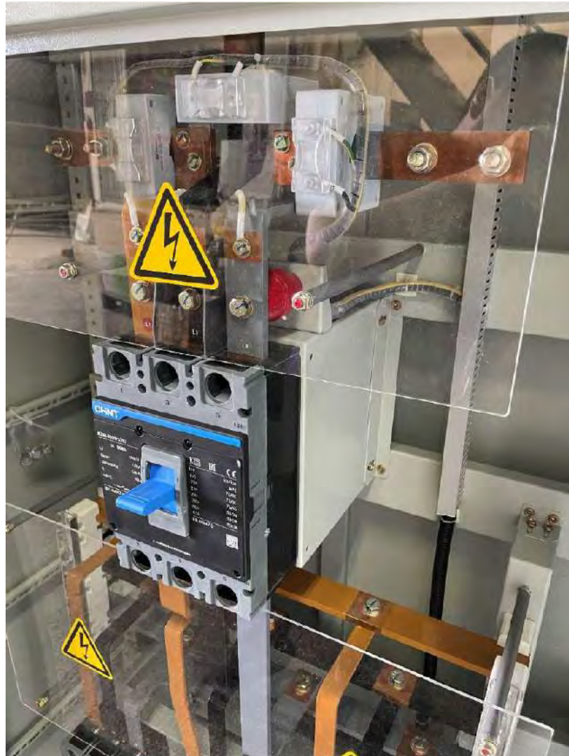
รูปที่ 4.16 ตู้ MDB 800A ติดตั้งเคอร์เรนทรานฟอมเมอร์
