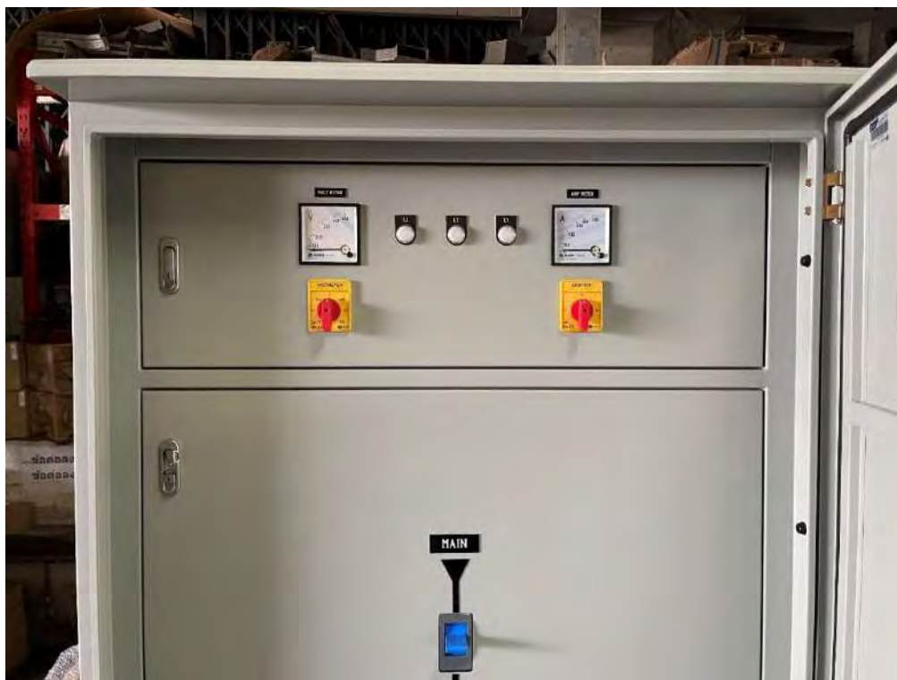
รูปที่ 4.13 ตู้ MDB 800A โวลต์มิเตอร์ แอมป์มิเตอร์
