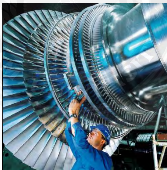
รูปที่ 2.5 เครื่องกังหันไอน้ำ (Steam Turbine)
