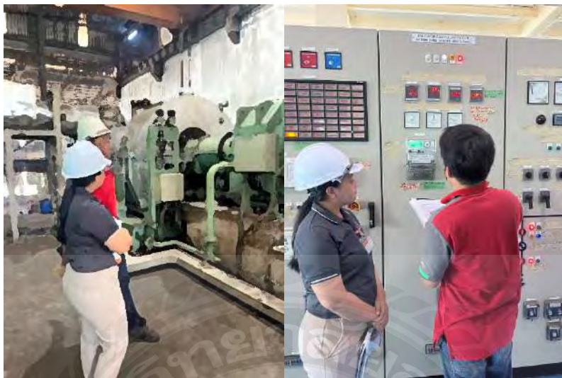
รูปที่ 3.1 เข้าร่วมสังเกตการตรวจประเมิน ณ โรงไฟฟ้าพลังความร้อนจากชีวมวลจังหวัดชลบุรี
