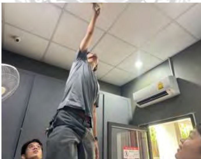
รูปที่ 4.2.2 การตรวจเช็คอุปกรณ์ตรวจจับควัน (Smoke Detector)
