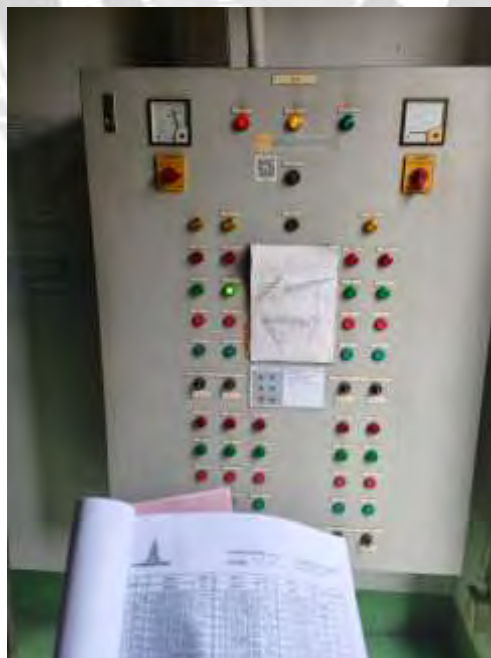
รูปที่ ก 10 ตรวจสอบเช็คข้อมูลระบบไฟป้่ม
