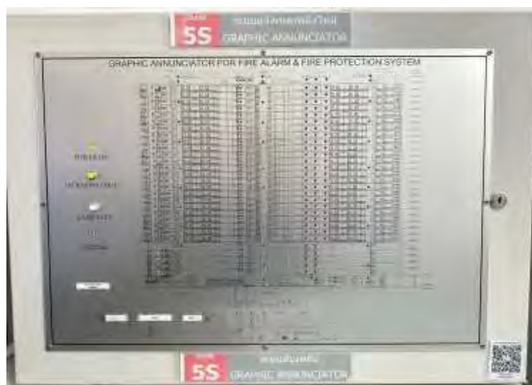
รูปที่ 4.2 เซ็คตู้แสดงสถานะแจ้งเหตุเพลิงไหม้
