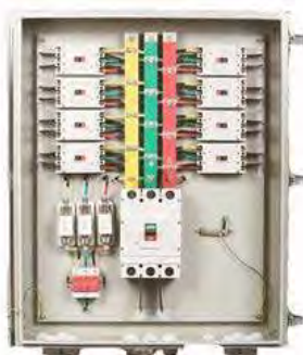
รูปที่ 2.38 DC Busbar of Combiner Box
