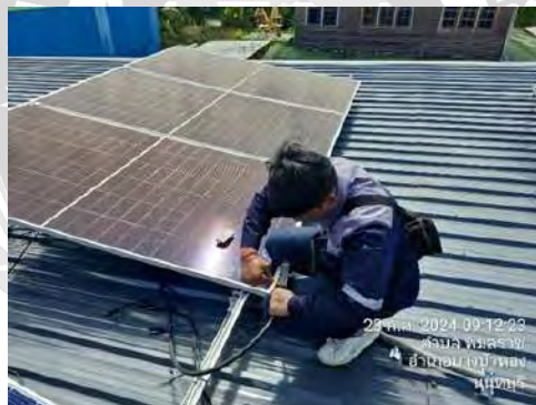
รูปที่ 4.6 การวางแผงพลังงานแสงอาทิตย์เพื่อเตรียมการต่อสายไฟฟ้าก่อนจับยึดแน่น
