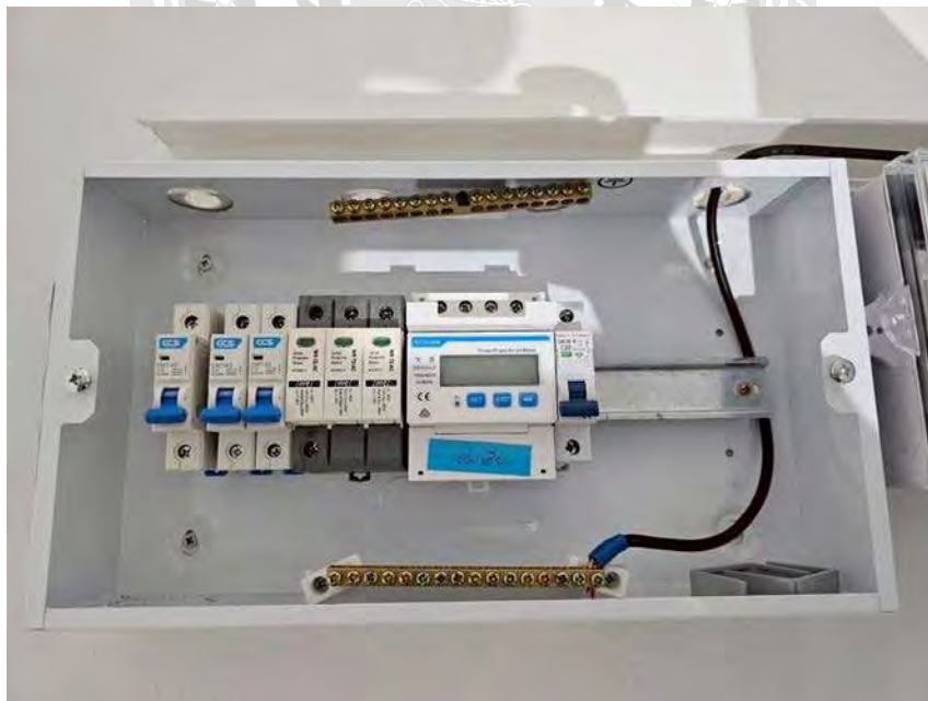
งานติดตั้งอุปกรณ์ป้องกันทางไฟฟ้าก่อนส่งจ่ายใช้งาน
