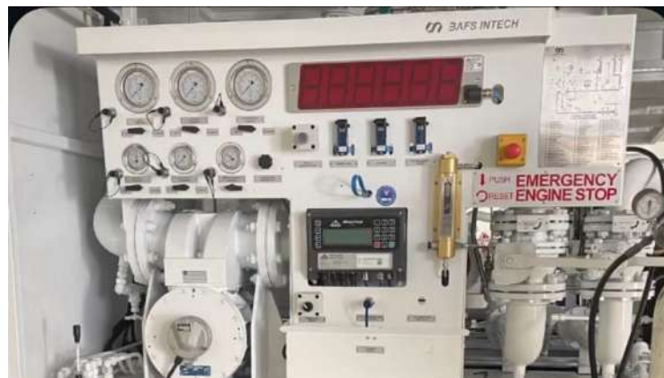
รูปที่ 2.22 แผงควบคุมหลัก (Control Panel)
