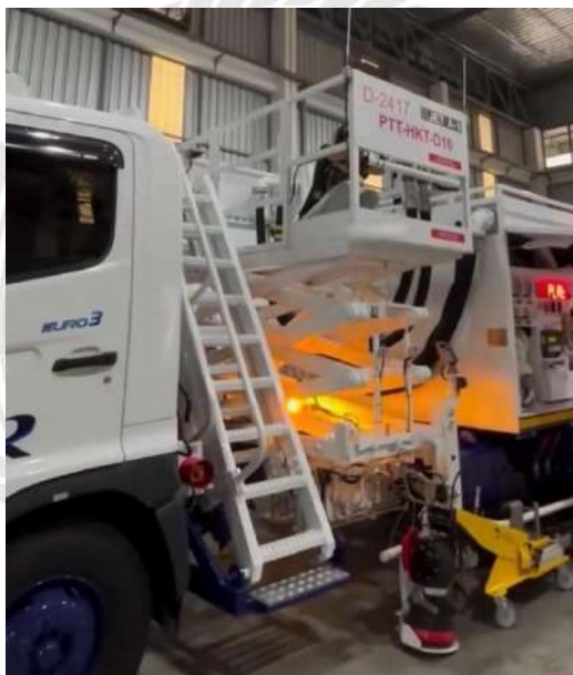
รูปที่ 4.12 การตรวจสอบการเดินสายและอุปกรณ์ที่ติดตั้ง
