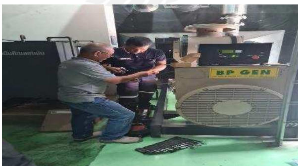
รูปที่ 4.2.10 เครื่องกำเนิดไฟฟ้าสำรอง
