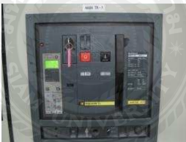
รูปที่ 4.2.6 AIR CIRCUIT BREAKER
