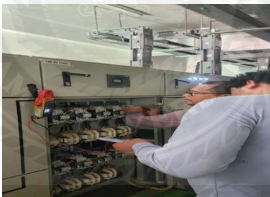
รูปที่ 4.2.9 CAPACITOR BANK
