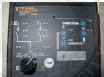
รูปที่ 4.2.8 AUTOMATIC TRANSFER SWITCH
