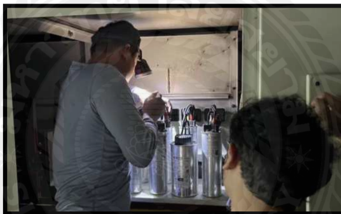
รูปที่2.4 PM ตู้คาปาซิเตอร์
