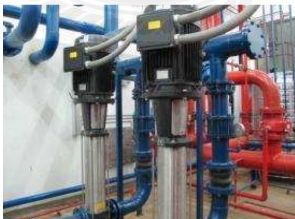
รูปที่ 4.2.11 เครื่องสูบน้ำดี CWP
