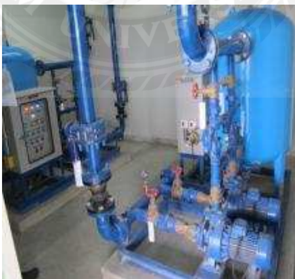
รูปที่ 4.2.12 ปั๊มน้ำเพิ่มแรงดัน
