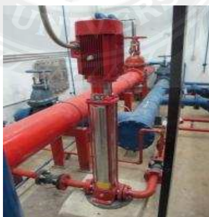
รูปที่4.2.14 เครื่องสูบน้ำดับเพลิง
