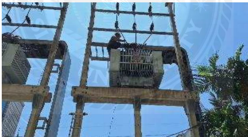
รูปที่4.2.5 หม้อแปลงอาคารสูง
