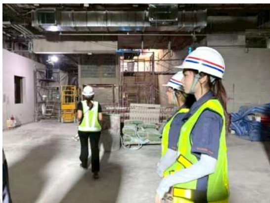
ภาพที่ 3.16 ตรวจเยี่ยมด้านความปลอดภัยฯ (Day Audit) โครงการก่อสร้างรถไฟฟ้าขนส่งมวลชน สายสีม่วง (ใต้) ช่วงเตาปูน-ราษฎร์บูรณะ สัญญาที่ 1 และ 2
