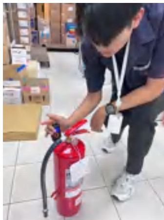
รูปภาพที่ 3.12 เช็คสภาพถังดับเพลิง ประจำ/เดือน
