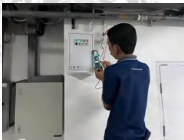
รูปภาพที่ 3.9 การตรวจสอบการใช้งานของระบบไฟฟ้า EMERGRGENCY LIGHT
