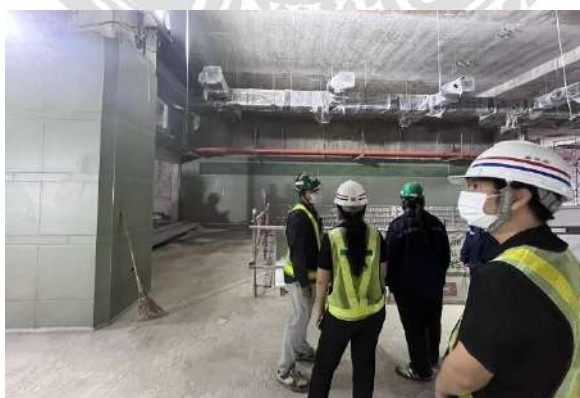
ภาพที่ 3.38 การตรวจเยี่ยมด้านความปลอดภัยฯ (Day Audit) โครงการก่อสร้างรถไฟฟ้าขนส่งมวลชน สายสีม่วง (ใต้) ช่วงเตาปูน-ราษฎร์บูรณะ สัญญาที่ 1 และ 2
