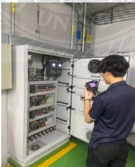
รูปที่ 4.2 การตรวจวัดอุณหภูมิตู้ควบคุมไฟฟ้า
