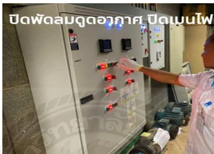
รูปที่ 4.17 ปิดพัดลมดูดอากาศที่เมนตู้ไฟฟ้า
