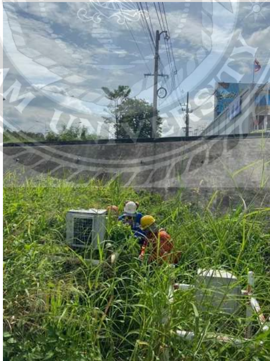
รูปที่ 4.14 ตำแหน่งที่ตั้งของ CP Test Post และระบบ AC mitigation
