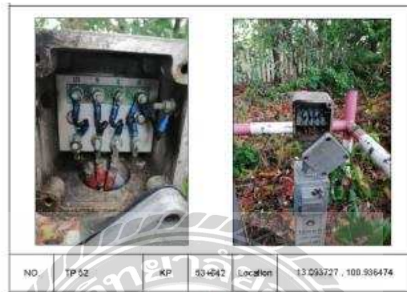
รูปที่ 4.2 ตำแหน่งการติดตั้งระบบ AC mitigation และ Cathodic Protection
