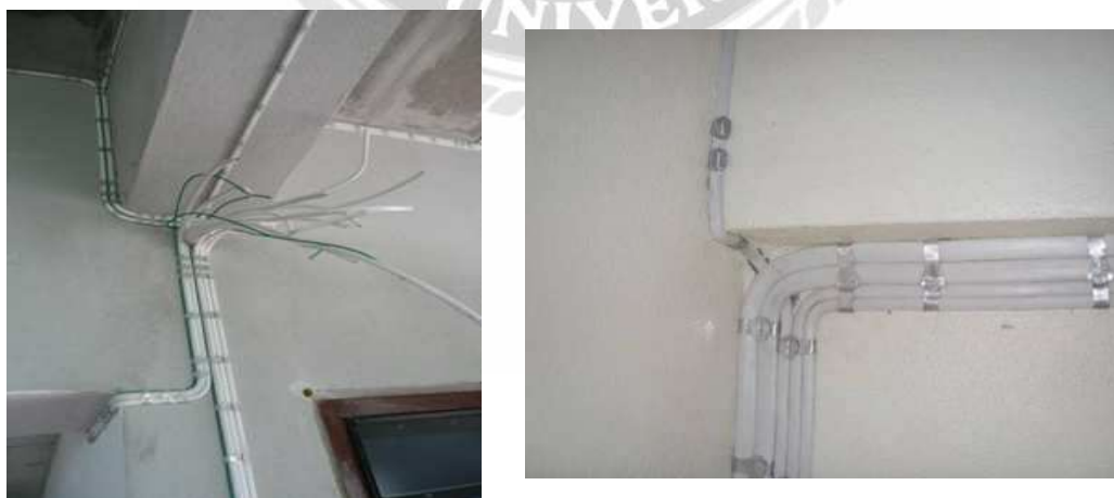
รูปที่ 2.4 การเดินสายไฟแบบเปิด (เดินลอย)
