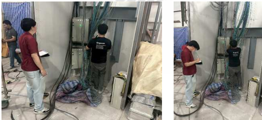
รูปที่ 4.1 ตรวจสอบการต่อสายตู้คอลโทร
