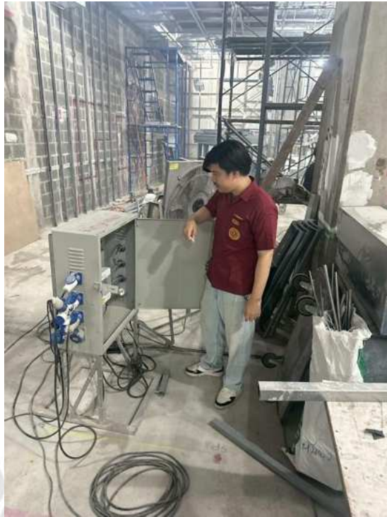
รูปที่ ก.5 เช็คและตรวจสอบตู้พาวเวอร์ปลั๊ก
