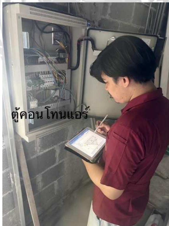
รูปที่ ก.2 ตรวจสอบการต่อสายตู้คอลโทรแอร์
