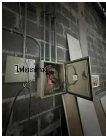
รูปที่ 4.3 ตรวจสอบการต่อสายไฟอราม
