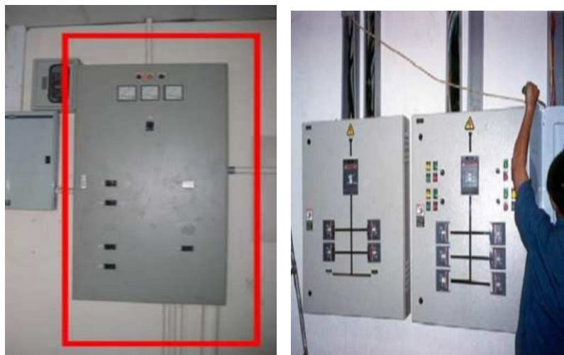
รูปที่ 2.16 ตู้ควบคุมรอง SDB (Sub Distribution Board)
