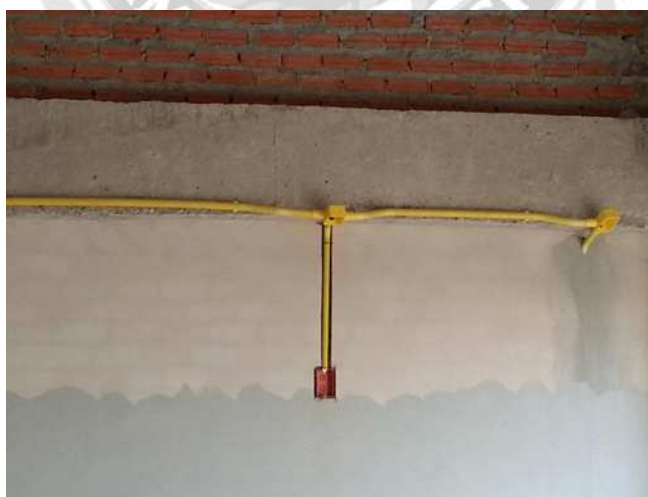
รูปที่ 2.6 การเดินสายไฟแบบปิด แบบซ่อนสายในท่อ
