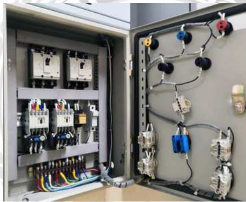
รูปที่ 3.3 ตู้คอนโทรลไฟฟ้า
