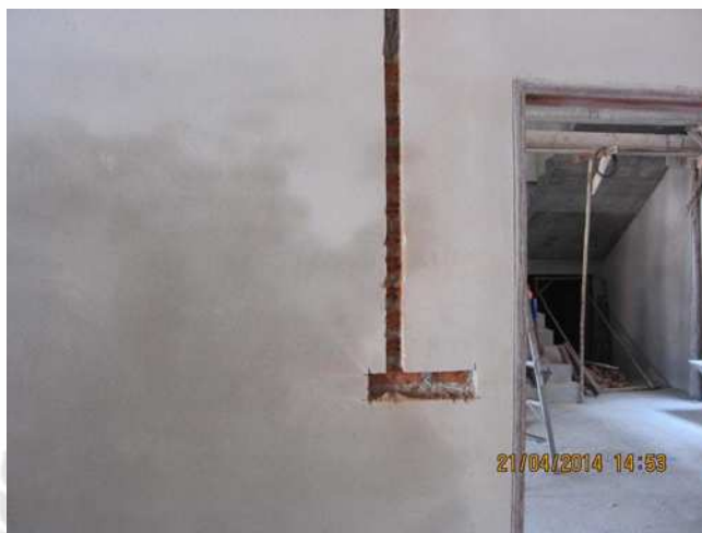
รูปที่ 2.5 การเจาะผนังเพื่อวางตำแหน่งท่อร้อยสายไฟ
