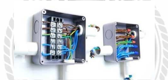
รูปที่ 3.9 กล่องแยกสายไฟ
