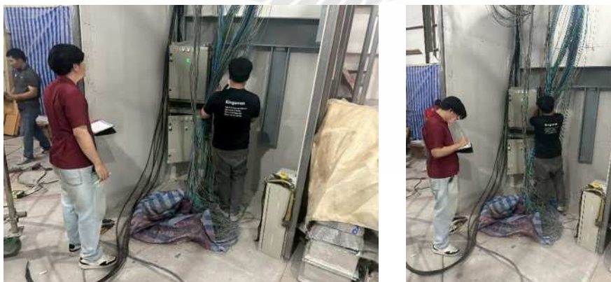
รูปที่ 4.1 ตรวจสอบการต่อสายตู้คอลโทร
