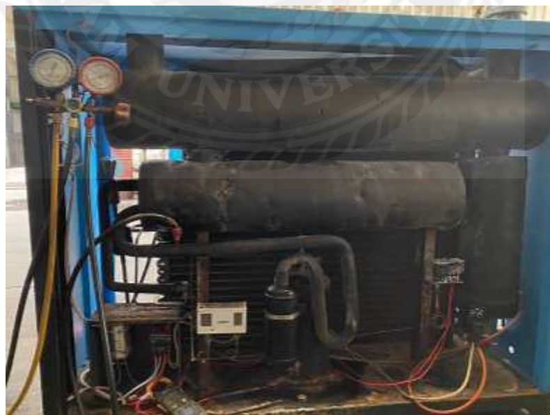
รูปที่ 4.3 ศึกษาการทำงานของ Air Dryer
