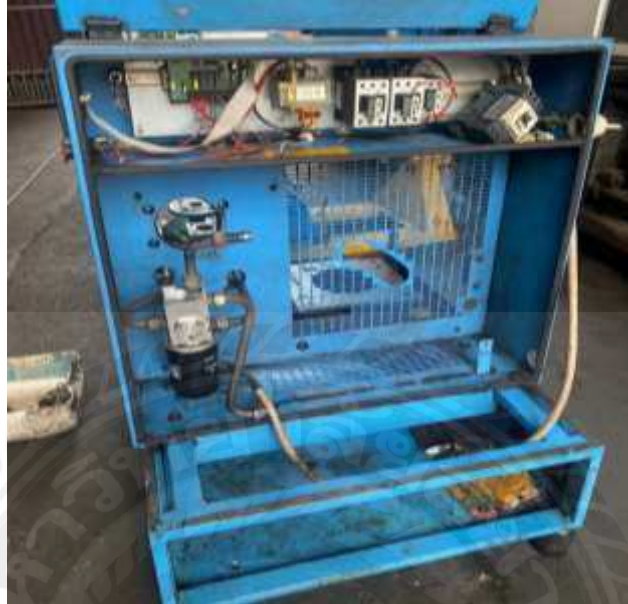
รูปที่ 4.16 ปั๊มลมก่อนติดตั้ง
