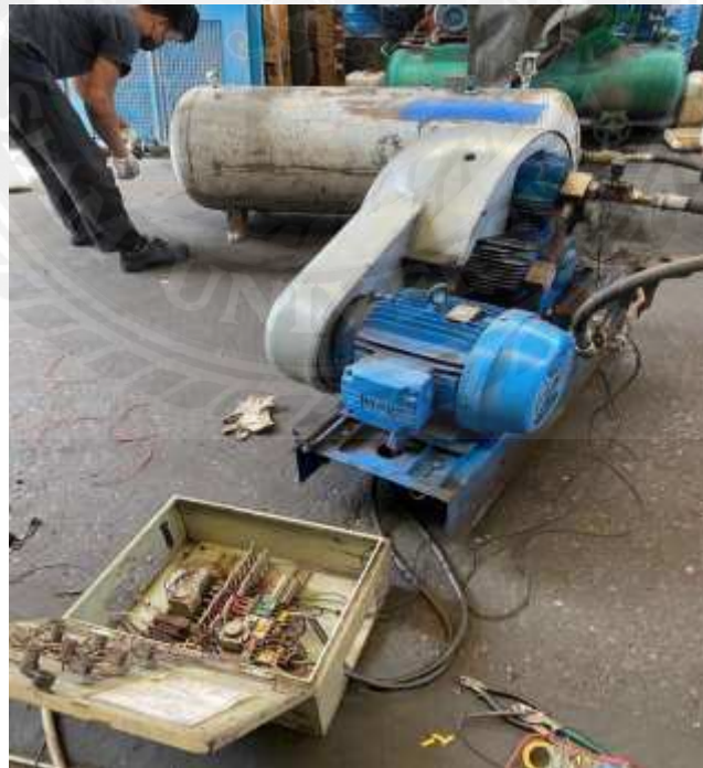
รูปที่ 4.25 ทำการต่อตู้คอนโทรลระบบควบคุมปั๊มลม
