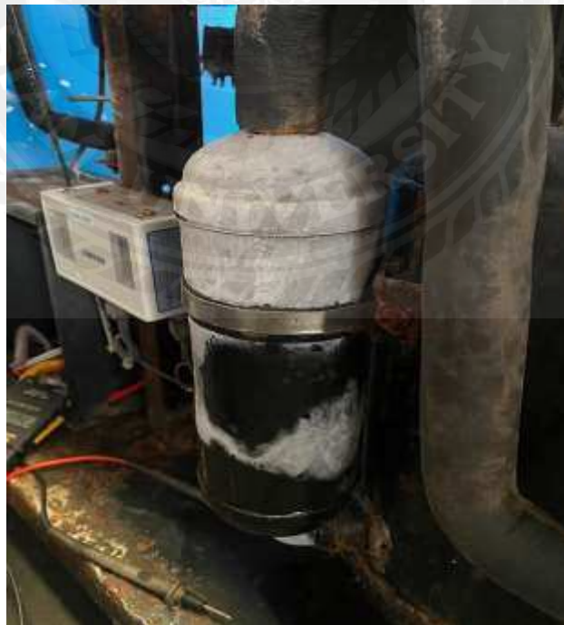
รูปที่ 4.11 เช็คระบบความชื้นของ Air Dryer
