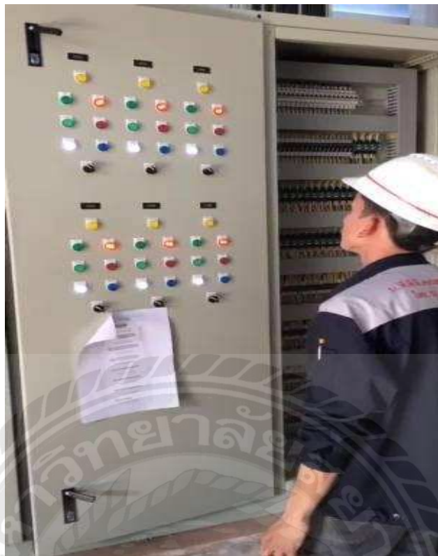
รูปที่ 3.9 ตรวจสอบเช็คการทำงานชุดคอนโทรล
