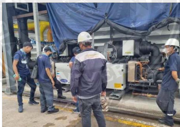
รูปที่ 3.10 อ่อนไฟฟ้าทดสอบระบบ
