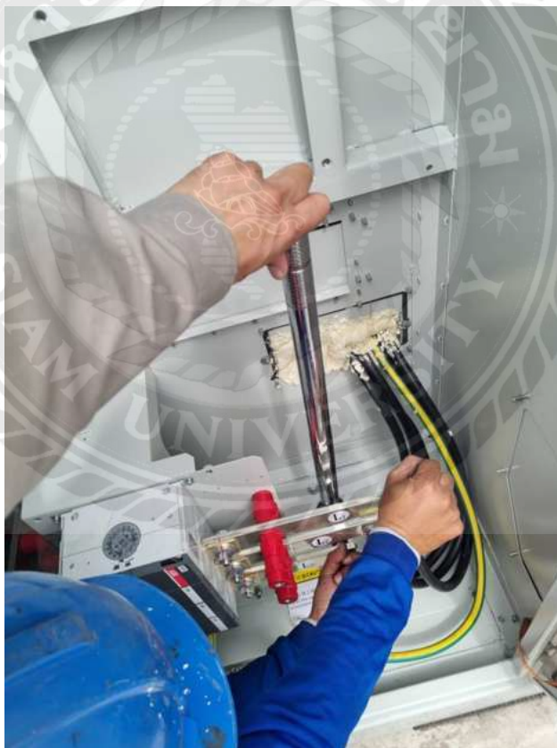
รูปที่ 3.6 ตรวจสอบการขันทอร์คน็อตหัวสายไฟฟ้า
