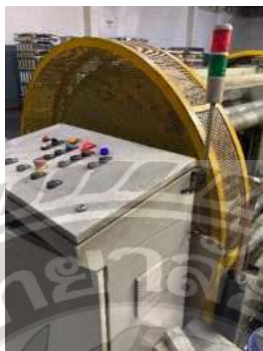
รูปที่ 2.8 แผงควบคุมเครื่องกลับเหล็ก
