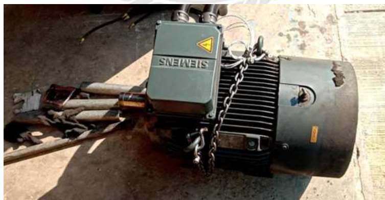
รูปที่ 4.16 ทำการถอดมอเตอร์ไฟฟ้าเพื่อตรวจสอบอย่างละเอียด (Over Haul)
