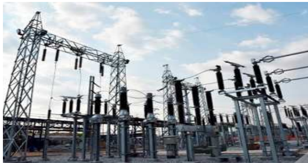
รูปที่ 2.16 สถานีจ่ายไฟฟ้าย่อยแบบฉนวนก้ำซัดความดัน
