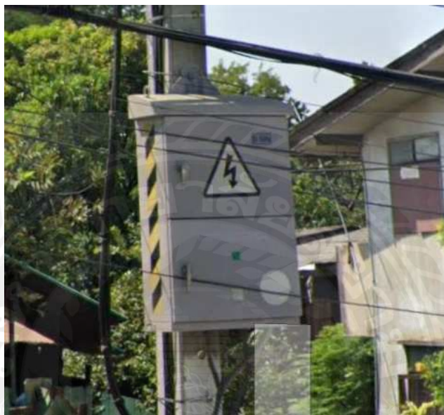
รูปที่ 2.4 ตู้ชุดควบคุม
