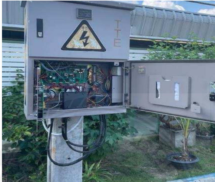
รูปที่ 4.5 ทำการติดตั้งกล่อง Fault Circuit Indicator ในตู้คอนโทรลของ Load Break
