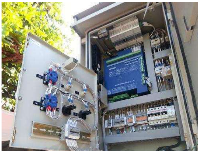
รูปที่ 2.7 Feeder Remote Terminal Unit (FRTU)
