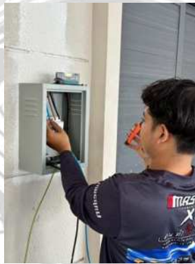
รูปที่ 4.6 การติดตั้ง EV Charger
