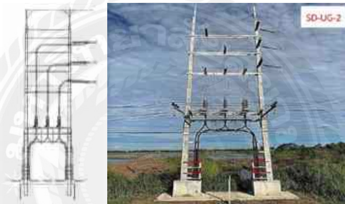
รูปที่ 2.38 ลักษณะของ Cable Riser Pole แบบ SD-UG-2
