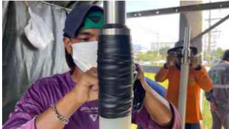
รูปที่ 4.89 ปิดช่องว่างระหว่าง Connection Bolt กับ เนื้อฉนวน และพันด้วย Insulation Tape
