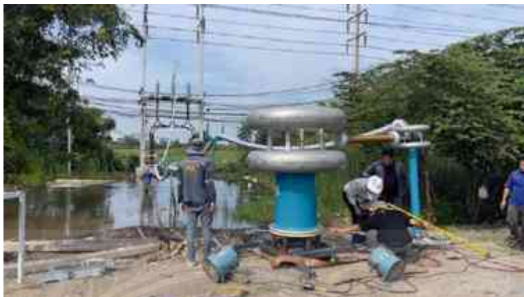
รูปที่ 4.113 การทดสอบแรงดันไฟฟ้ากระแสสลับ (AC Voltage Test) (1)
