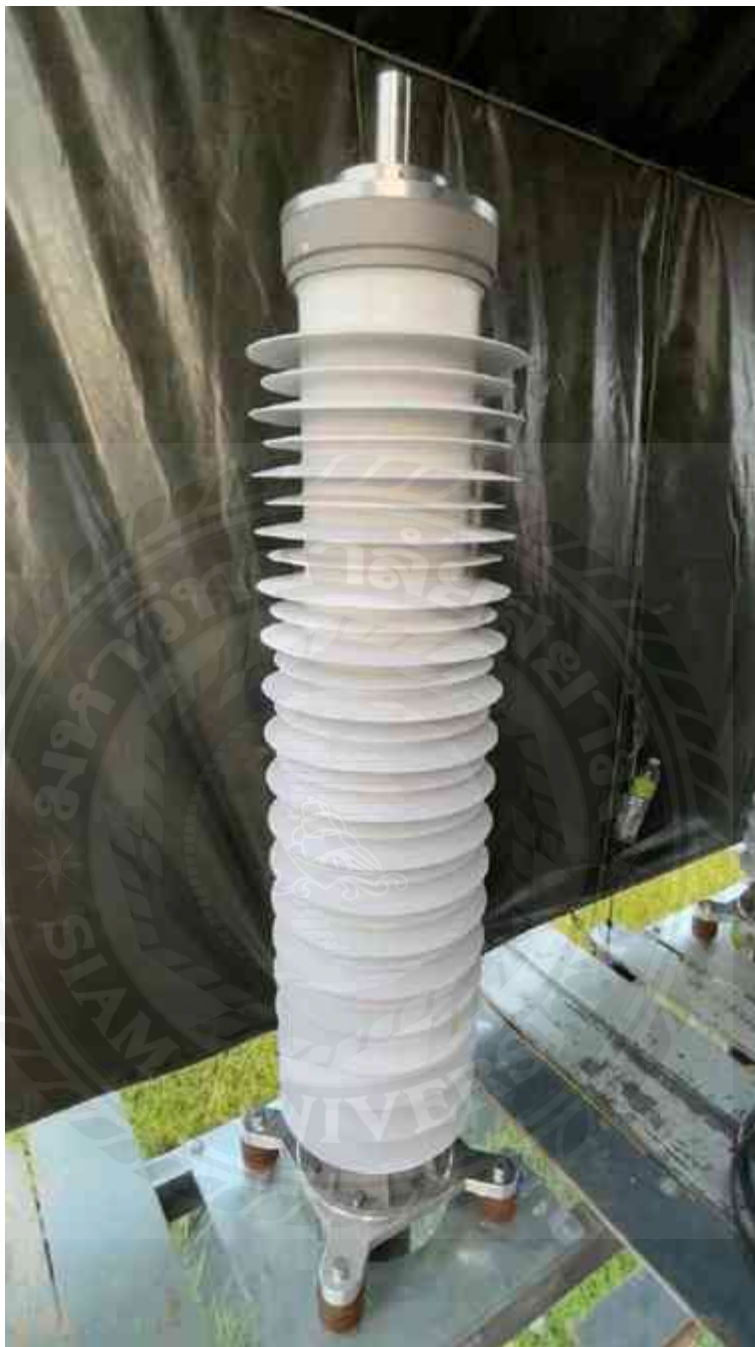
รูปที่ 4.102 ชุดต่อปลายสาย Termination เมื่อติดตั้งแล้วเสร็จ
