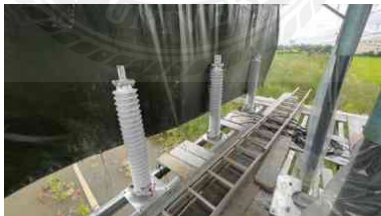
รูปที่ 4.108 ชุดกับดักเสิร์จแรงสูง เมื่อติดตั้งแล้วเสร็จ
