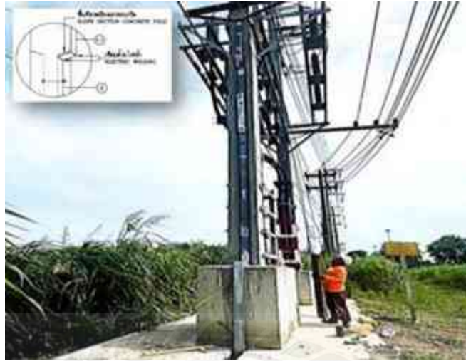
รูปที่ 2.47 ตัวอย่างการติดตั้งชุดป้องกันการโจรกรรมสายต่อลงดิน สำหรับโครงสร้างเสาขึ้นสายเคเบิลใต้ดินระบบ 115 กิโลโวลต์
