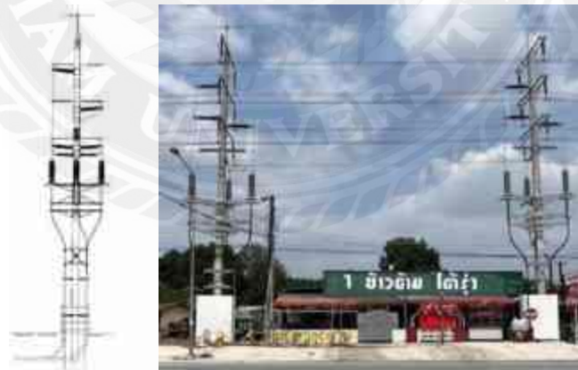
รูปที่ 2.41 ลักษณะของ Cable Riser Pole แบบเสาเดี่ยวใต้ไลน์ระบบสายส่ง ระดับแรงดัน 115 กิโลโวลต์
