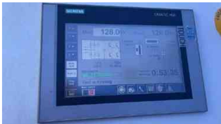
รูปที่ 4.116 หน้าจอแสดงค่าการทดสอบแรงดันไฟฟ้ากระแสสลับ (AC Voltage Test)
