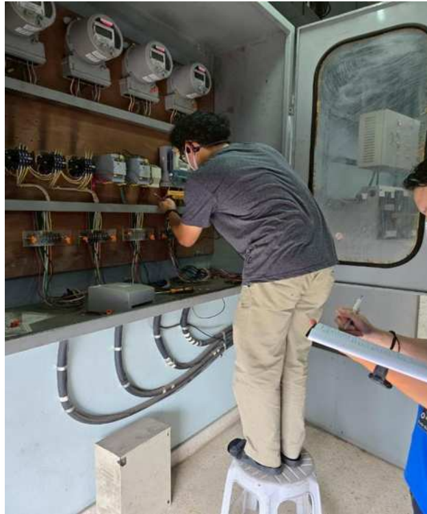
รูปที่ ค 1 ภาพการลงพื้นที่ตรวจมิเตอร์
