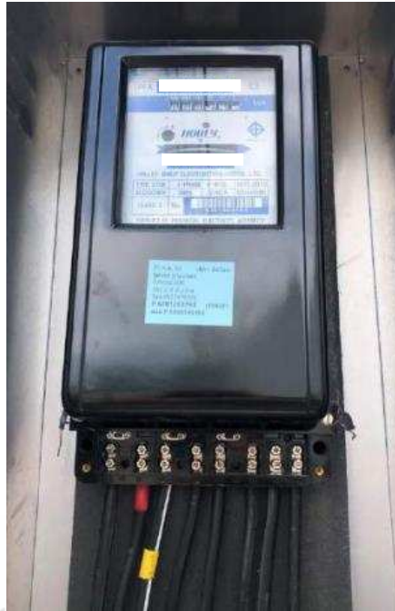
รูปที่ 4.4 การติดตั้งมิเตอร์ 3 เฟส 4 สาย
