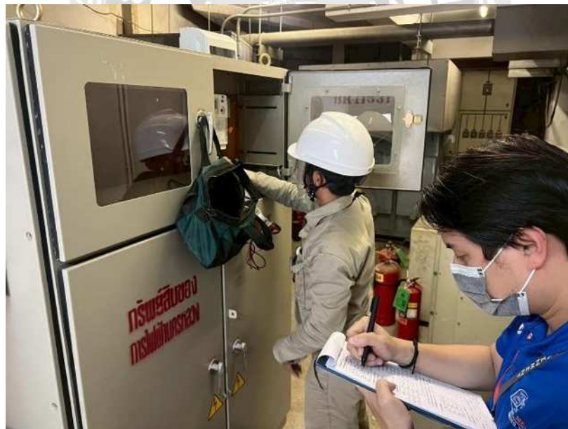
รูปที่ ค 2 ภาพการลงพื้นที่ตรวจมิเตอร์
