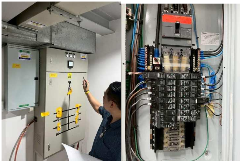
รูปที่ 3.43 ตรวจสอบความปลอดภัยตู้ MDB
