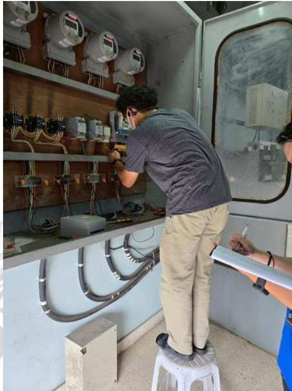
รูปที่ ค 3 การตรวจสอบมิเตอร์และการเก็บค่าดีมานด์
