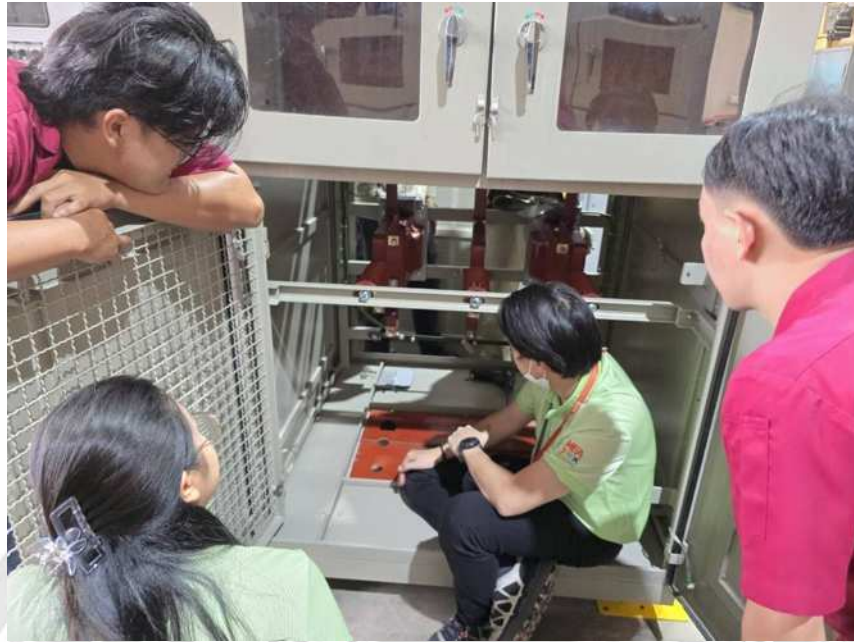
รูปที่ ค 7 การติดตั้ง CT VT แรงสูงในตู้สายใต้ดิน
