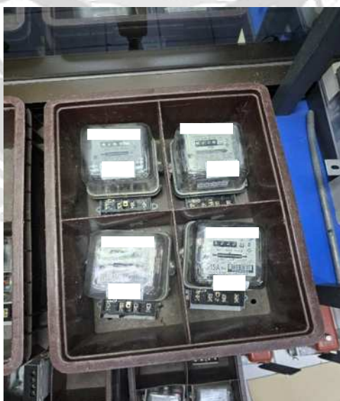
รูปที่ 4.1 เครื่องวัดหน่วยไฟฟ้า 5(15) A
