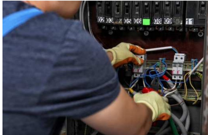
รูปที่ 2.7.3 ขั้นตอนที่ 3 การเชื่อมต่อสายไฟ
