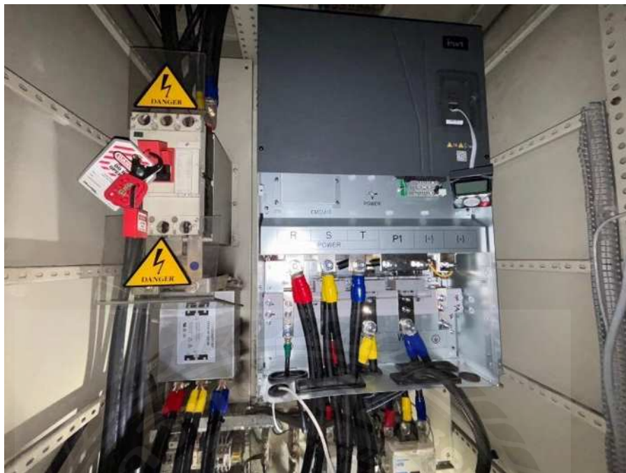
ติดตั้งเครื่อง Inverter รุ่น GD350A
