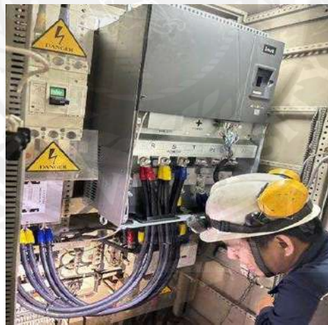
รูปที่ 4.2.14 ตรวจสอบเช็คหน้างาน ก่อนเปิดเครื่อง
