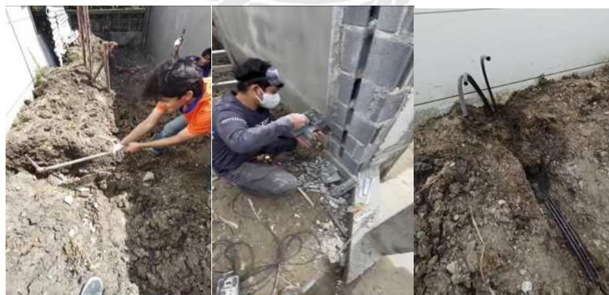
รูปที่ 3.20 การขุดฝังท่อ HDPE ระบบไฟฟ้านอกอาคาร
