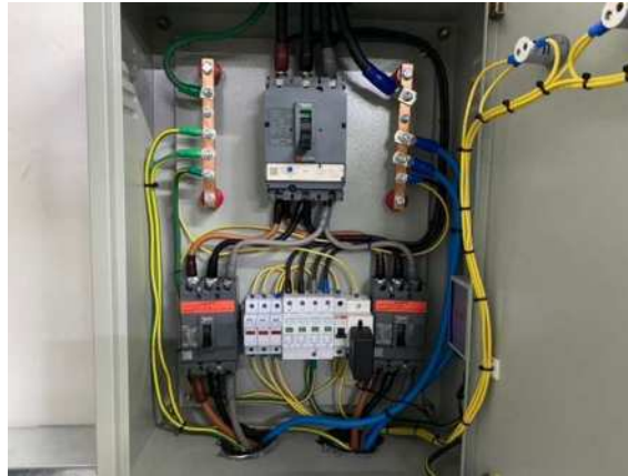
รูปที่ 4.11 เบรกเกอร์ ควบคุมอินเวอร์เตอร์ทั้งสองตัว
