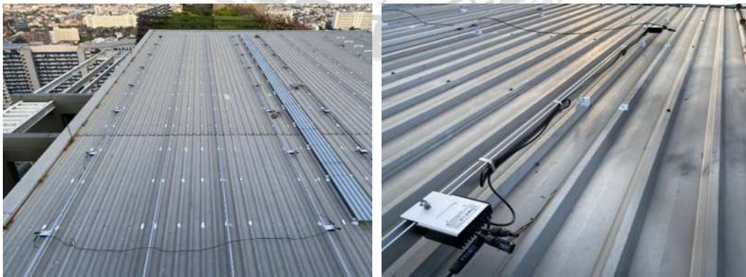
รูปที่ 4.6 ติดตั้งพาวเวอร์ออฟทีไมค์เซอร์ (power optimizer)
