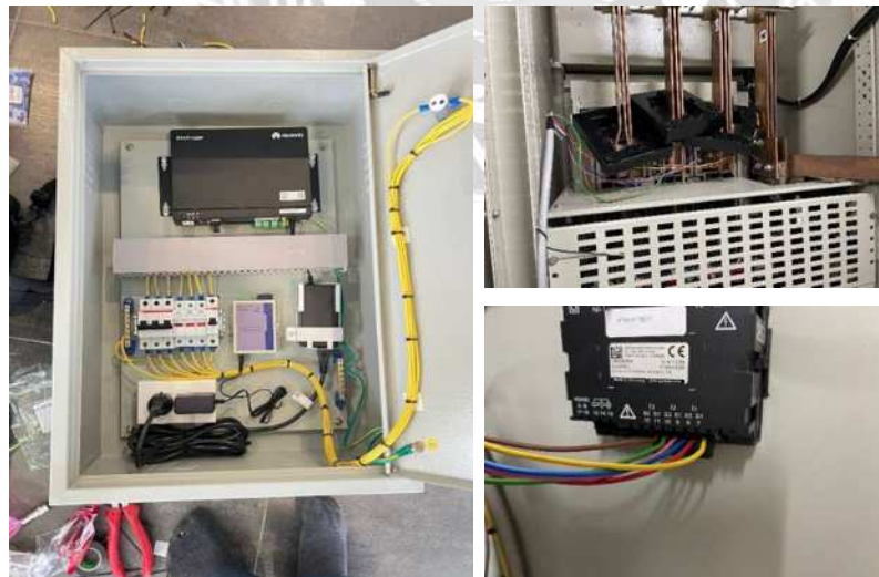
รูปที่ 4.12 ชุดควบคุม CT กันย้อน
