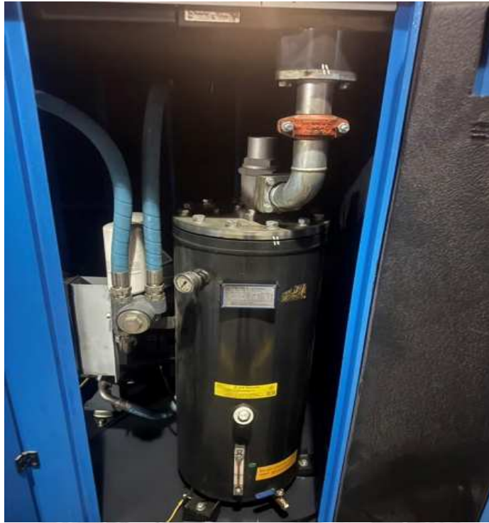
รูปที่ ก9. ถังน้ำมันภายในเครื่องปั๊มลม
