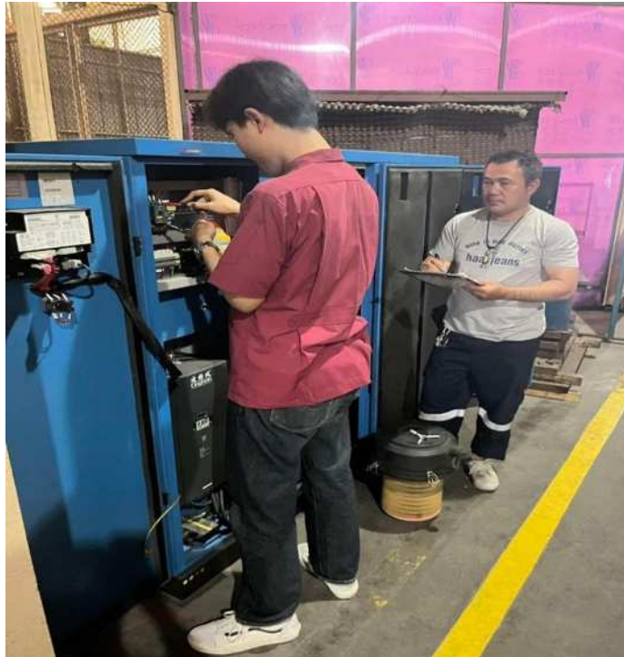
รูปที่ ก5. การตรวจเช็คระบบไฟของเครื่องปั๊มลม
