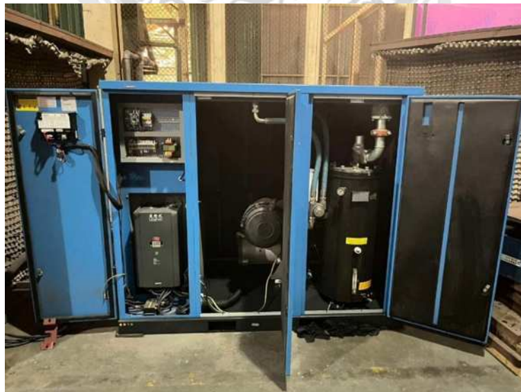
รูปที่ ก8. ภายในเครื่องปั๊มลม
