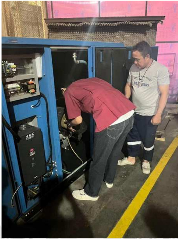
รูปที่ ก7. การทำความสะอาดกรองอากาศของเครื่องปั๊มลม
