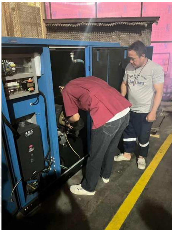
รูปที่ 4.7 การทำความสะอาดกรองอากาศของเครื่องปั๊มลม
