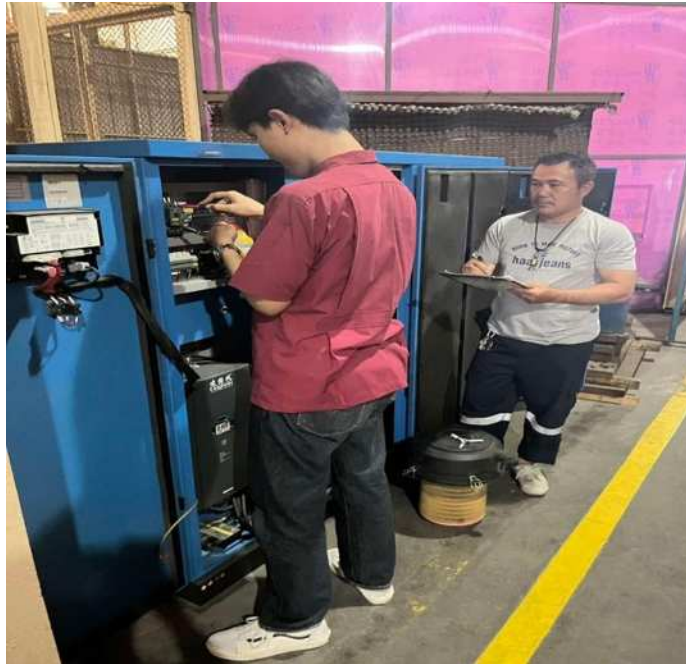
รูปที่ 4.5 การตรวจเช็คระบบไฟของเครื่องปั๊มลม
