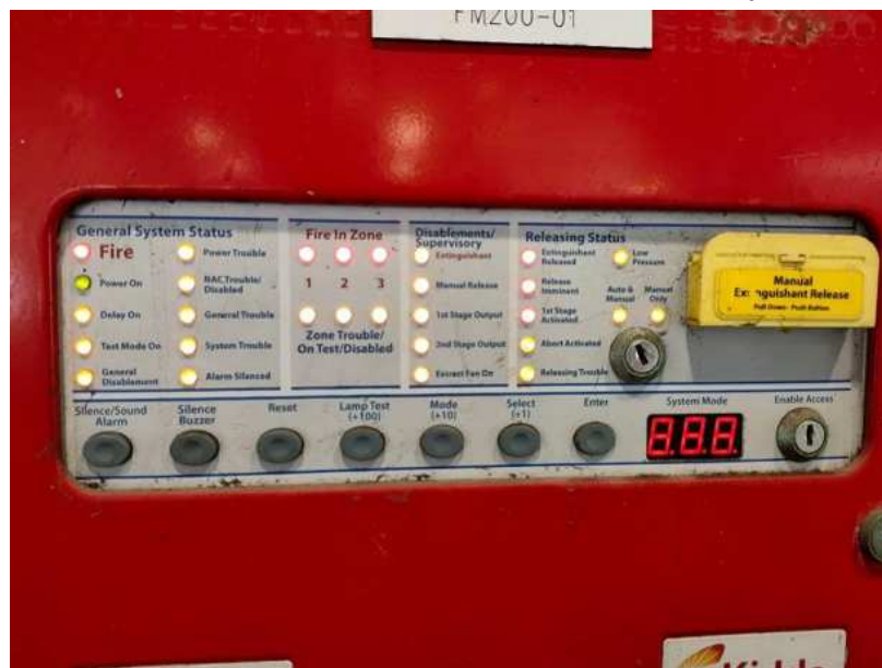
รูปที่ 4.20 ตรวจสอบสถานการณ์ทำงานหน้าตู้ควบคุม
