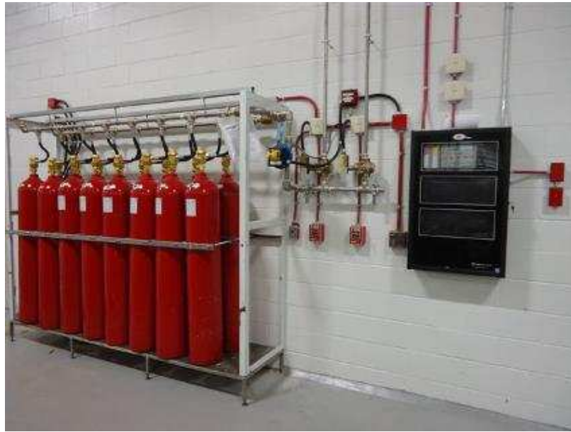
รูปที่ 2.24 ระบบดับเพลิงอัตโนมัติด้วยก๊าซไนโตรเจน (IG 100)
