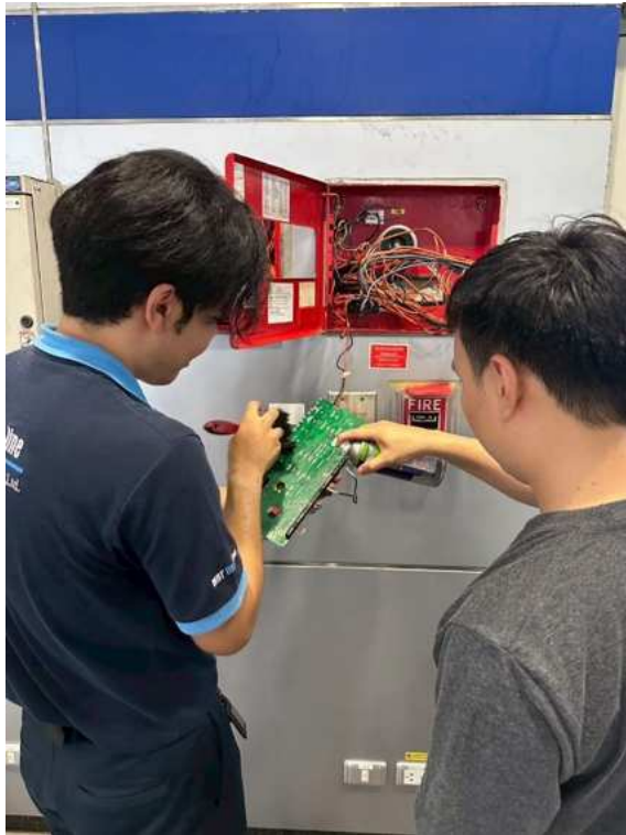
รูปที่ 4.22 ตรวจสอบแผงควบคุม
