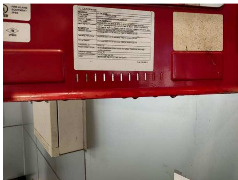
รูปที่ 4.21 พบไหลน้ำเข้าตู้ควบคุม
