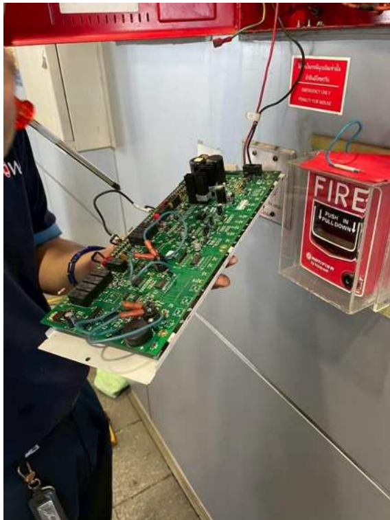
รูปที่ 4.23 ตรวจสอบแผงควบคุม (ต่อ)
