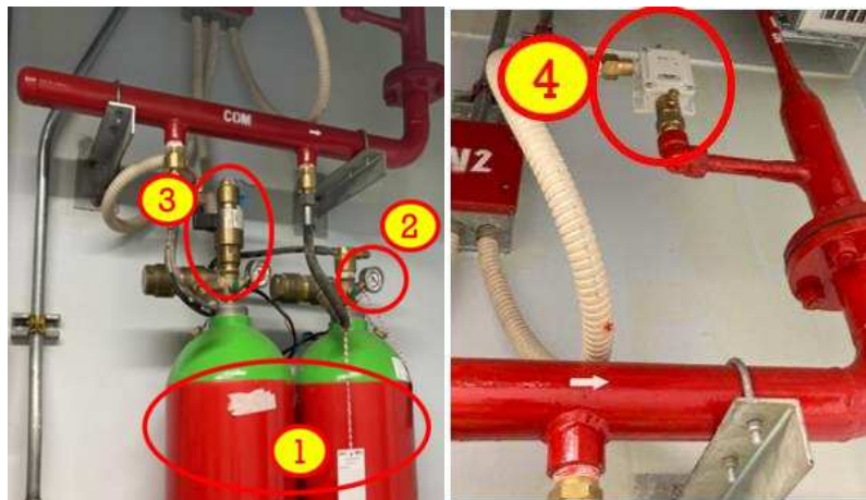
รูปที่ 4.6 ตำแหน่งส่วนประกอบ Gas Suppression Cylinders
