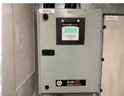
รูปที่ 2.11 Automatic Transfer Switch ( ATS )
