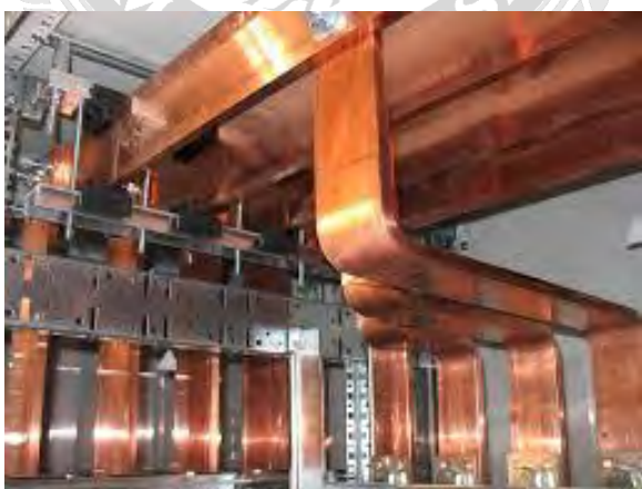
รูปที่ 2.7 บัสบาร์ ( Busbar )
