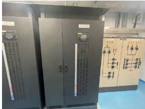
รูปที่ 2.12 Uninterruptable Power Supply ( UPS )
