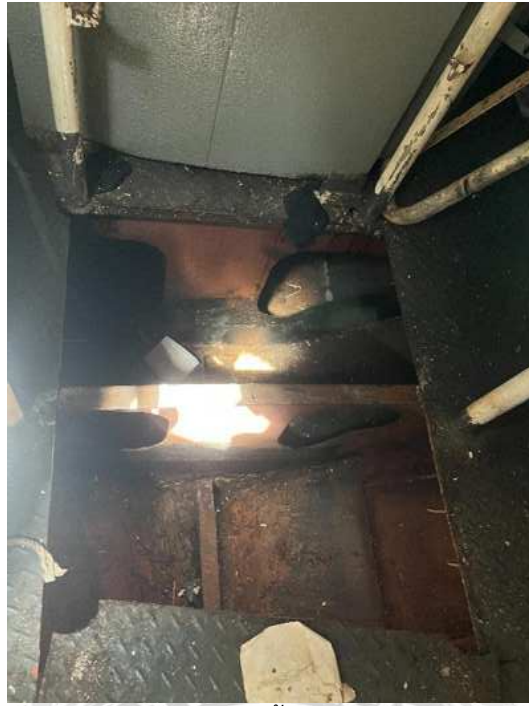
รูปที่ 3.7 จุดที่จะดำเนินการติดตั้งสวิทช์ลุ่มลอย Float Switch
