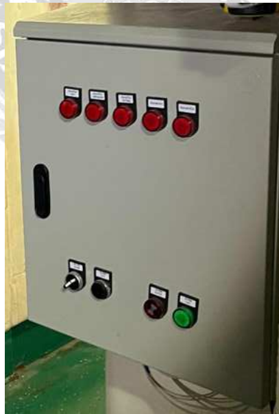
รูปที่ 4.3 ตู้ควบคุมระบบเตือนน้ำท่วมเรือที่ได้รับการติดตั้ง
