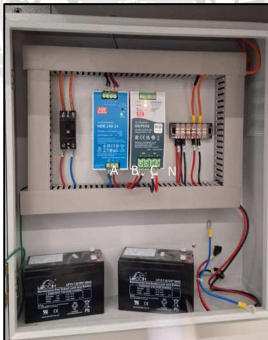
รูปที่ 3.12 ทำการติดตั้งอุปกรณ์ ตู้ Power Supply
