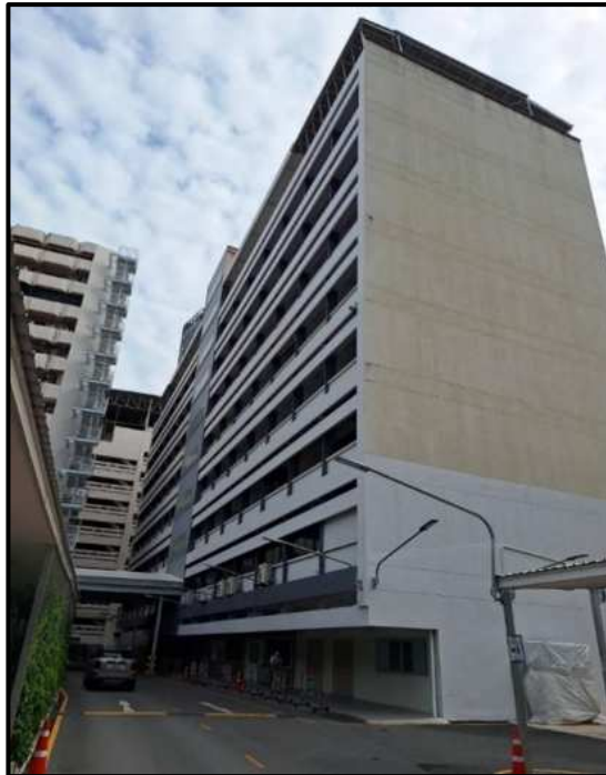
รูปที่ 3.3 อาคารที่ทำการติดตั้งระบบแจ้งเหตุเพลิงไหม้ (Fire Alarm System)
