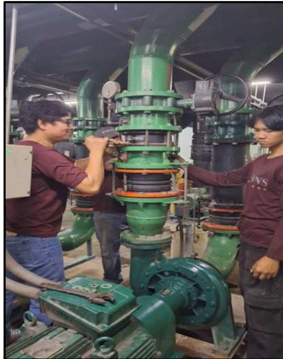
รูปที่ 3.29 ตรวจสอบการทำงานของปั้มน้ำ และการไหลของน้ำในระบบ
