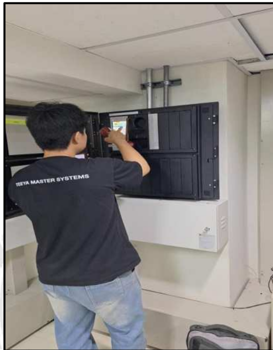
รูปที่ 3.15 ทำการทดสอบตู้ควบคุมสัญญาณแจ้งเหตุเพลิงไหม้ (Fire Alarm Control Panel)
