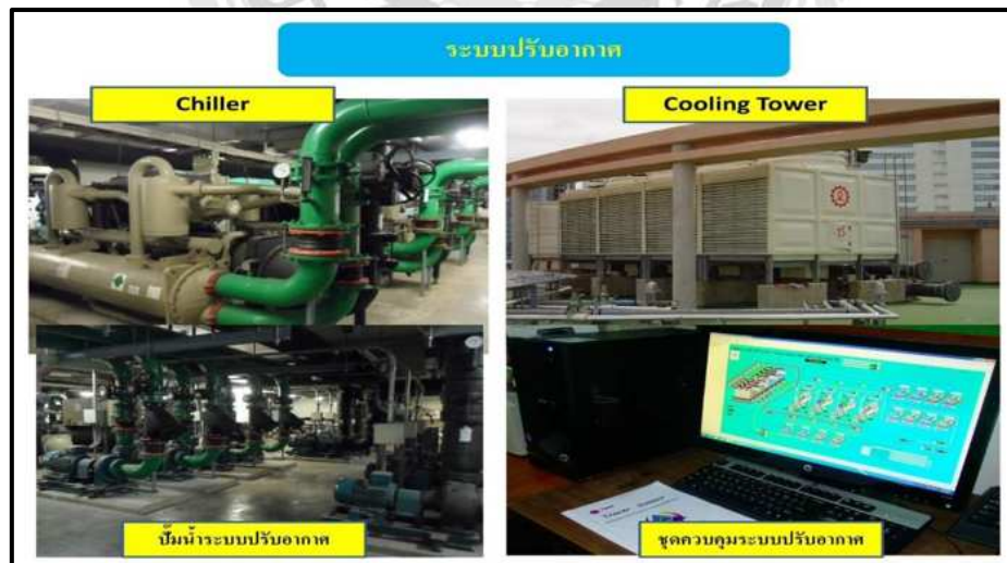
รูปที่ 3.25 ระบบปรับอากาศ
