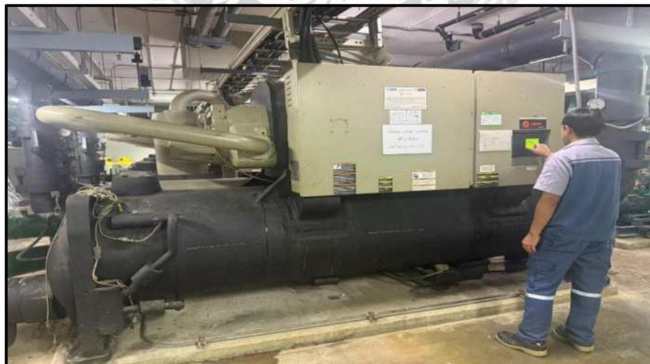
รูปที่ 3.30 ตรวจสอบระบบไฟฟ้า Control Panel และสัญญาณ Alarm
