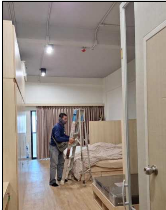
รูปที่ 3.9 ทำการติดตั้งอุปกรณ์ตรวจจับ เช่น เครื่องตรวจจับควัน
