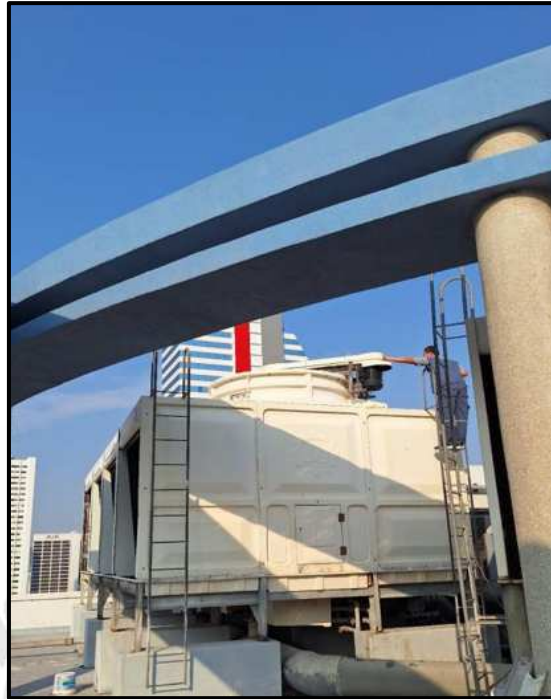
รูปที่ 3.31 ตรวจการทำงานของ Cooling Tower และระดับน้ำ
