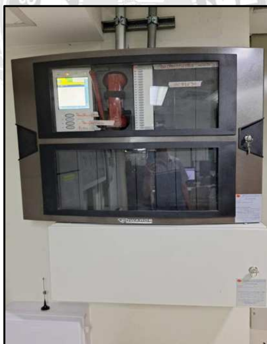
รูปที่ 3.14 ทำการติดตั้งตู้ควบคุมสัญญาณแจ้งเหตุเพลิงไหม้ (Fire Alarm Control Panel)
