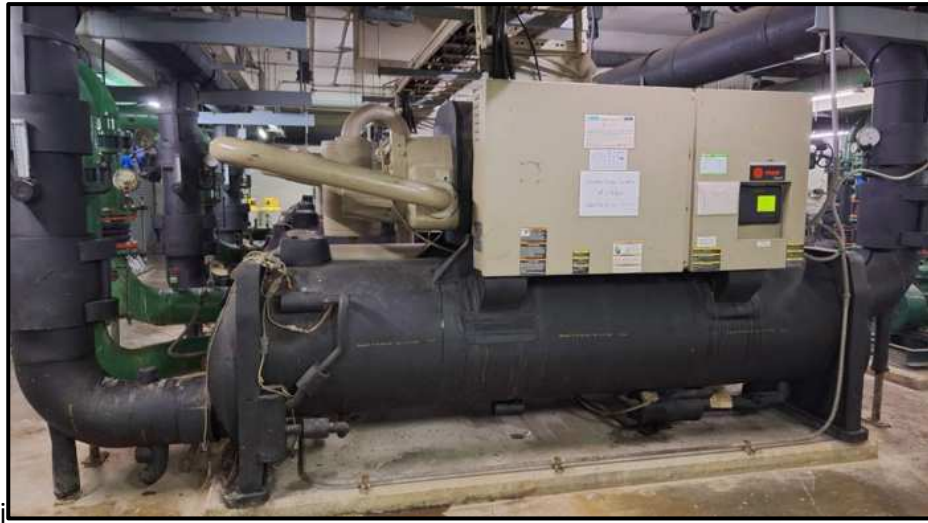
รูปที่ 3.26 Chiller
