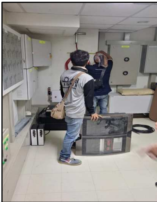
รูปที่ 3.5 สถานที่ติดตั้งตู้ควบคุมสัญญาณแจ้งเหตุเพลิงไหม้ (Fire Alarm Control Panel)
