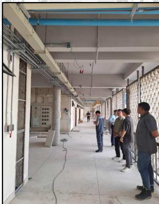
รูปที่ 3.4 สถานที่ติดตั้งระบบแจ้งเหตุเพลิงไหม้ (Fire Alarm System)
