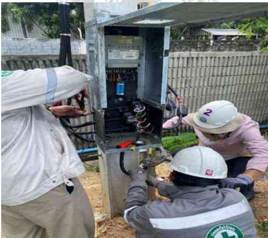
รูปที่ 3.79 การติดตั้งมิเตอร์และอุปกรณ์ประกอบ CT แรงต่ำ 3 เฟส 4 สาย
