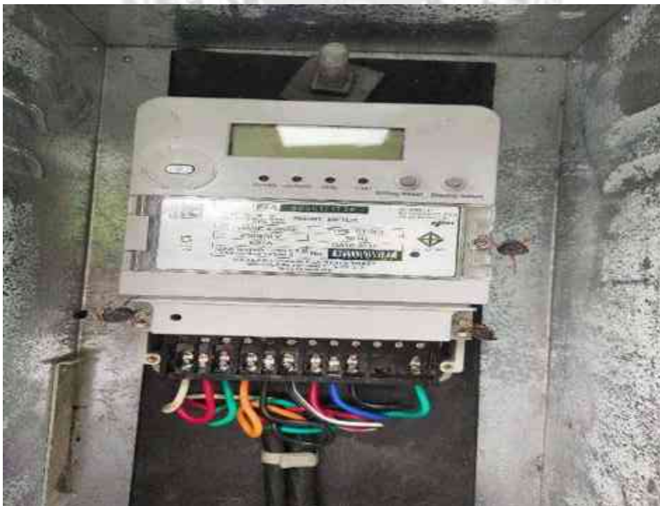
รูปที่ 3.125 การสับเปลี่ยนมิเตอร์และอุปกรณ์ประกอบ CT แรงต่ำ 3 เฟส 4 สาย
