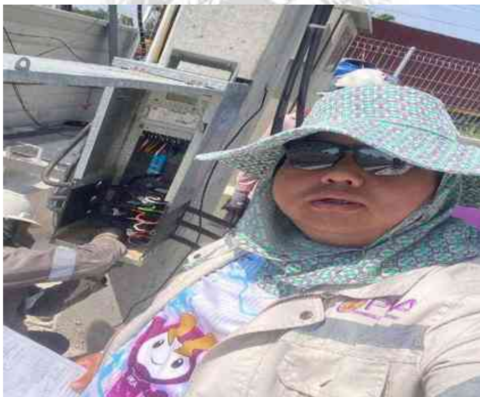
รูปที่ 3.85 การติดตั้งมิเตอร์และอุปกรณ์ประกอบ CT แรงต่ำ 3 เฟส 4 สาย
