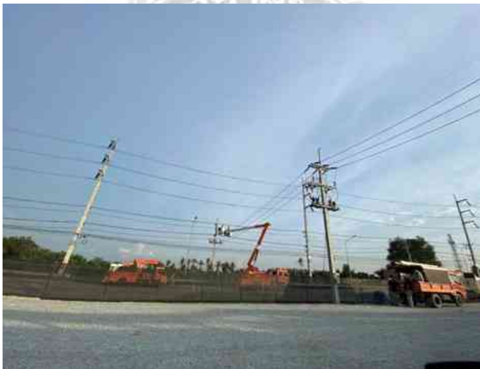
รูปที่ 3.153 ดำเนินการจ่ายไฟหลังการติดตั้งแล้วเสร็จ
