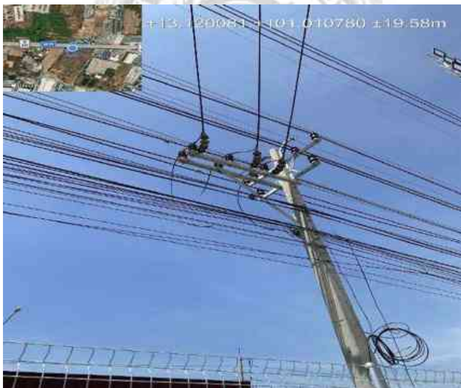
รูปที่ 3.87 ยังไม่ดำเนินการจ่ายไฟหลังการติดตั้งมิเตอร์เสร็จ เนื่องจากยังไม่ได้เชื่อมไลน์แรงสูง
