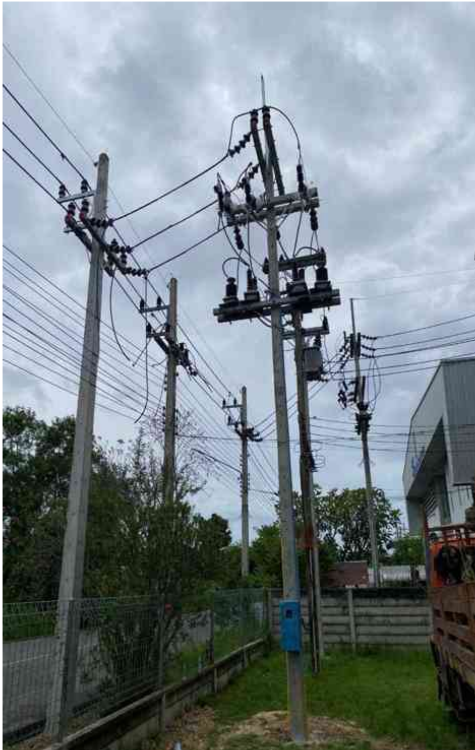
รูปที่ 3.148 ยังไม่ดำเนินการจ่ายไฟหลังการติดตั้งมิเตอร์เสร็จ เนื่องจากยังไม่ได้เชื่อมไลน์แรงสูง
