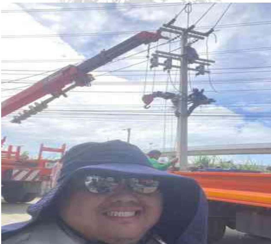
รูปที่ 3.170 ดำเนินการติดตั้ง มิเตอร์แบบประกอบ ซีที วีที แรงสูง 3 เฟส 3 สาย
