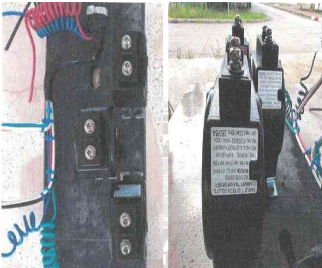
รูปที่ 3.3 ตัวอย่าง นำ CT แรงต่ำที่จะใช้งานติดตั้งยึดติดเข้ากับแป้นยึดพร้อมยึดสายไฟฟ้า
