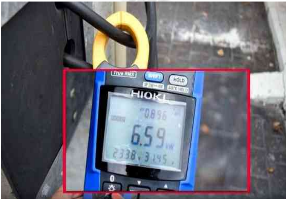
รูปที่ 3.46 ตัวอย่าง ทำการอ่านค่าที่แสดงบนคลิปปอนกิโลวัตต์ และจดบันทึกผลการวัด ของเฟส A ไว้
