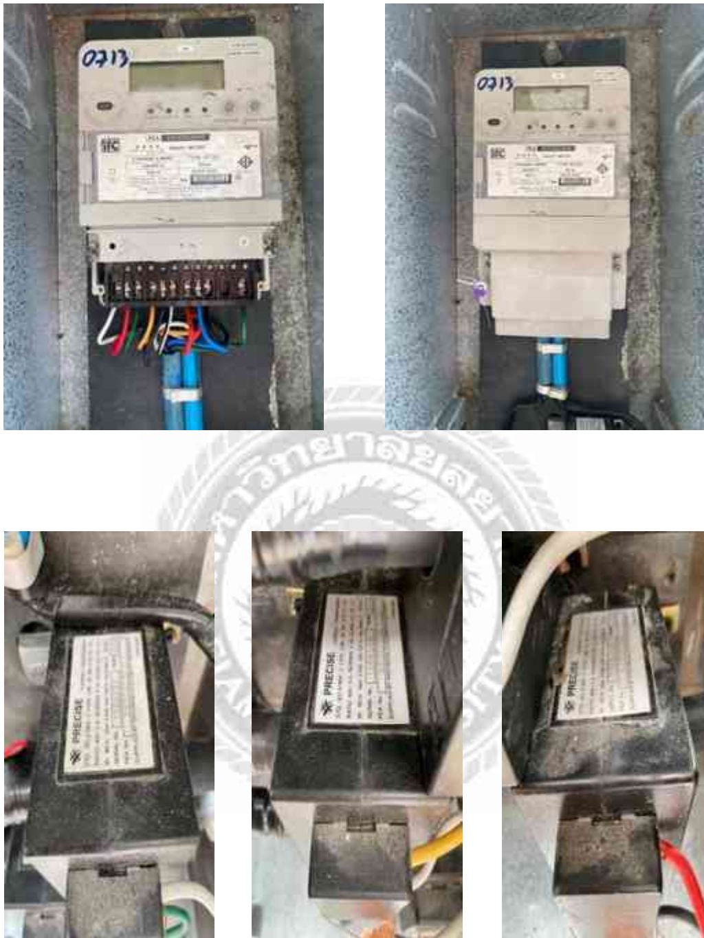
รูปที่ 3.113 การติดตั้งมิเตอร์และอุปกรณ์ประกอบ CT แรงต่ำ 3 เฟส 4 สาย
