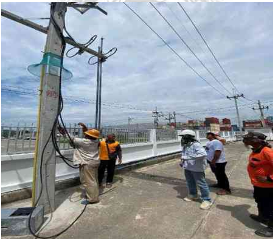
รูปที่ 3.121 การติดตั้งมิเตอร์และอุปกรณ์ประกอบ CT แรงต่ำ 3 เฟส 4 สาย
