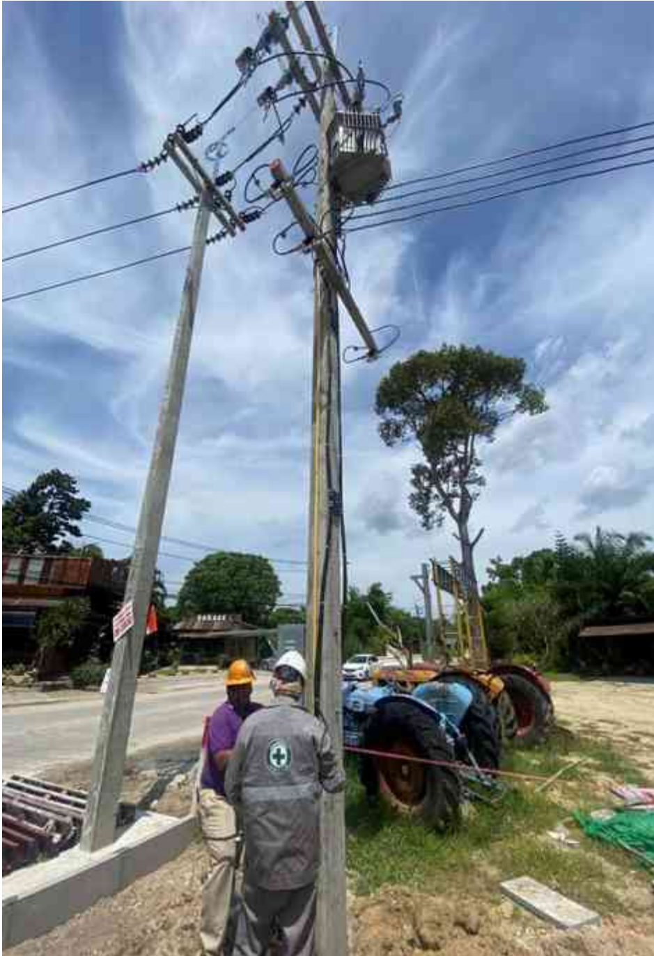
รูปที่ 3.17 ตัวอย่าง การติดตั้งมิเตอร์และอุปกรณ์ประกอบ CT แรงต่ำ
