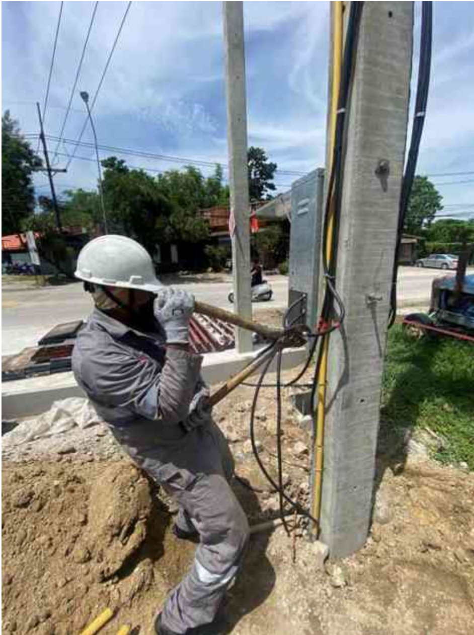
รูปที่ 3.15 ตัวอย่าง การติดตั้งมิเตอร์และอุปกรณ์ประกอบ CT แรงต่ำ
