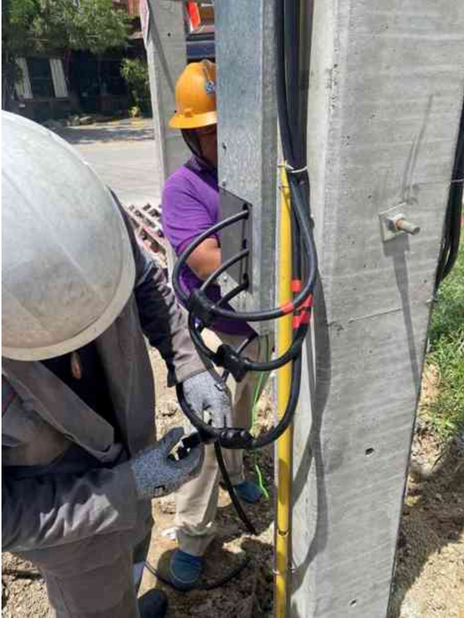
รูปที่ 3.16 ตัวอย่าง การติดตั้งมิเตอร์และอุปกรณ์ประกอบ CT แรงต่ำ
