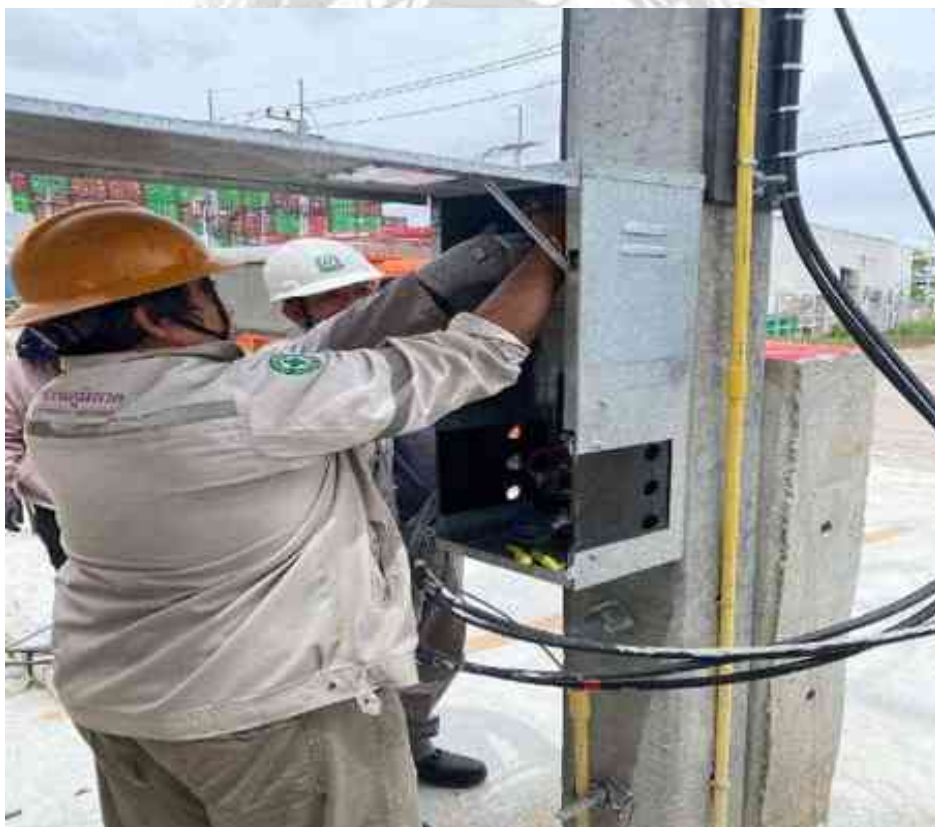
รูปที่ 3.107 การติดตั้งมิเตอร์และอุปกรณ์ประกอบ CT แรงต่ำ 3 เฟส 4 สาย
