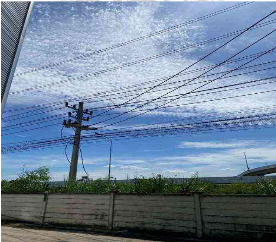
รูปที่ 3.172 ยังไม่ดำเนินการจ่ายไฟหลังการติดตั้งมิเตอร์เสร็จ เนื่องจากยังไม่ได้เชื่อมไลน์แรงสูง
