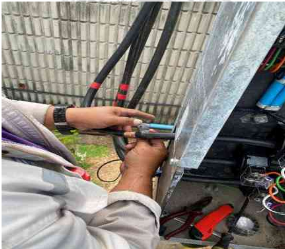
รูปที่ 3.80 การติดตั้งมิเตอร์และอุปกรณ์ประกอบ CT แรงต่ำ 3 เฟส 4 สาย
