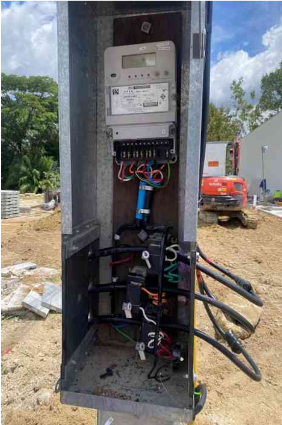
รูปที่ 3.19 ตัวอย่าง การติดตั้งมิเตอร์และอุปกรณ์ประกอบ CT แรงต่ำ และการวางเรียงสายที่หน้างานจริง
