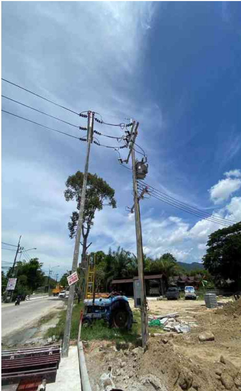
รูปที่ 3.100 ดำเนินการจ่ายไฟหลังการติดตั้งมิเตอร์แล้วเสร็จ
