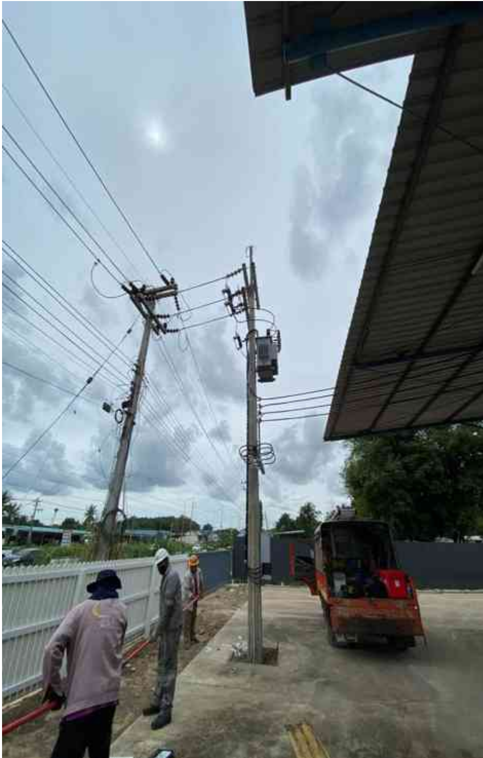
รูปที่ 3.114 ดำเนินการจ่ายไฟหลังการติดตั้งมิเตอร์แล้วเสร็จ
