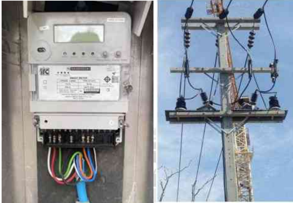
รูปที่ 2.22 ตัวอย่าง มิเตอร์ไฟฟ้าแรงสูง 22 และ 33 กิโลโวลต์ 3 เฟส 3 สาย 5(6) A
