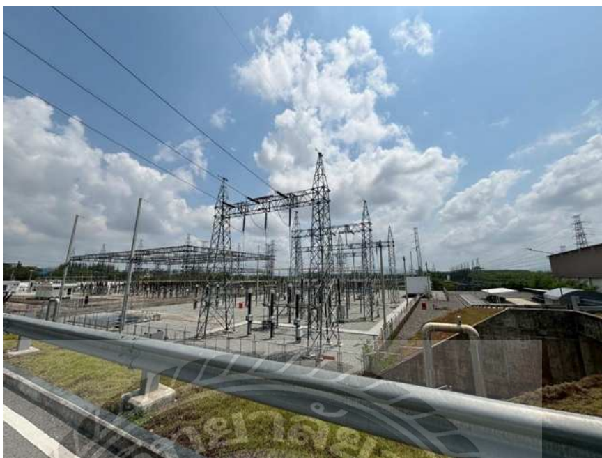
รูปที่ ก9 สถานีไฟฟ้า Substation 115 kV
