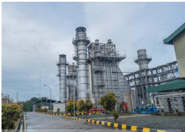
รูปที่ 2.9 เครื่องกำเนิดไอน้ำ HRSG
