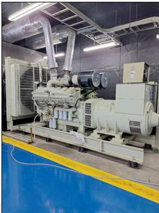
รูปที่ 3.48 เครื่องกำเนิดไฟฟ้า (Generator)
