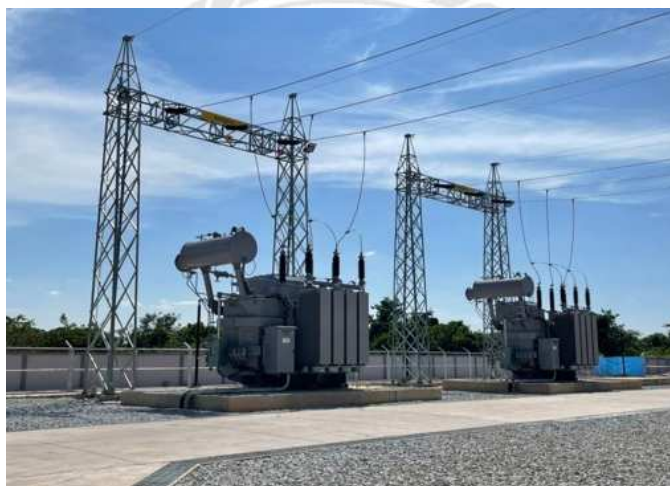
รูปที่ 2.18 สถานีการเปลี่ยนระดับแรงดันไฟฟ้า
