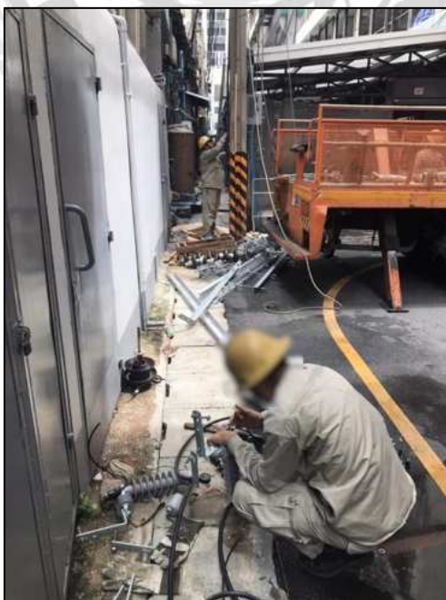
รูปที่ 3.37 เจ้าหน้าที่เตรียมอุปกรณ์ Surge Arrester
