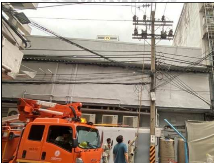
รูปที่ 3.10 เจ้าหน้าที่การไฟฟ้านครหลวงทำการตัดกระแสไฟออกจากหม้อแปลง
