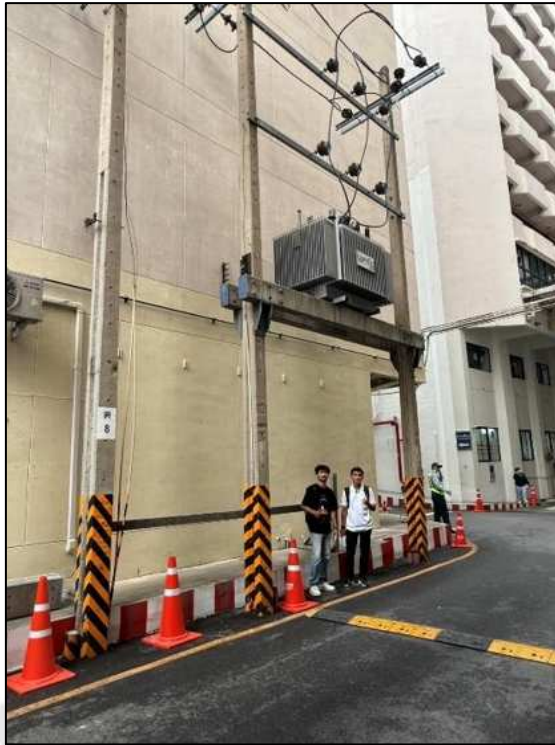
รูปที่ 3.7 สถานที่ติดตั้งหม้อแปลง (เก่า)
