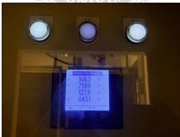
รูปที่ 3.42 ตรวจสอบการทำงานของระบบไฟฟ้า (1)
