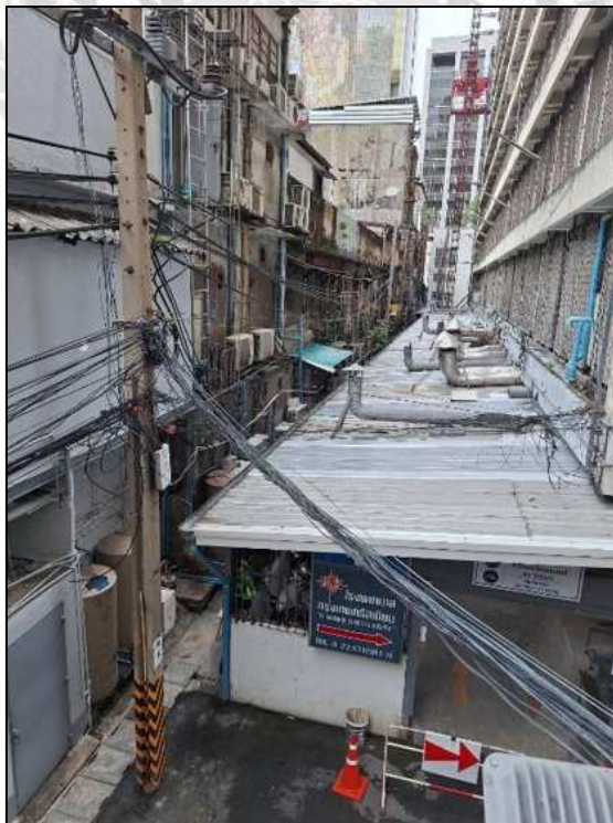
รูปที่ 3.8 สถานที่ติดตั้งหม้อแปลง (ใหม่)
