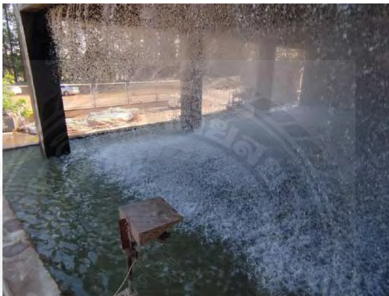
รูปที่ 3.7 อ่างน้ำเย็น
