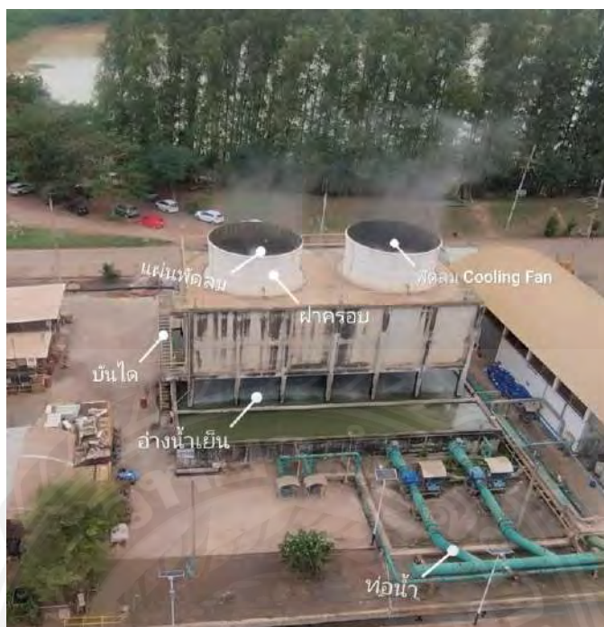
รูปที่ 3.4 ส่วนประกอบภายนอกของ Cooling Tower ขนาด 29.47 MW
