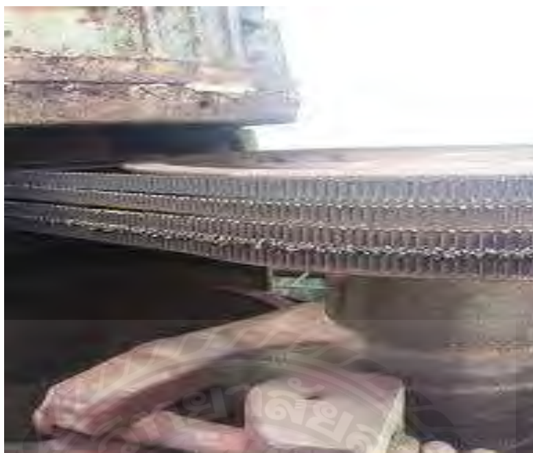
รูปที่ 3.10 สายพานพัดลม Cooling Tower
