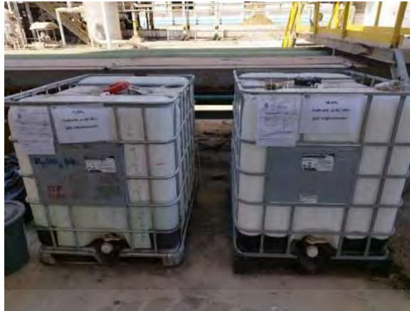
รูปภาพผนวกที่ ข.3 สารเคมี Sulfuric acid (pH adjustment)
