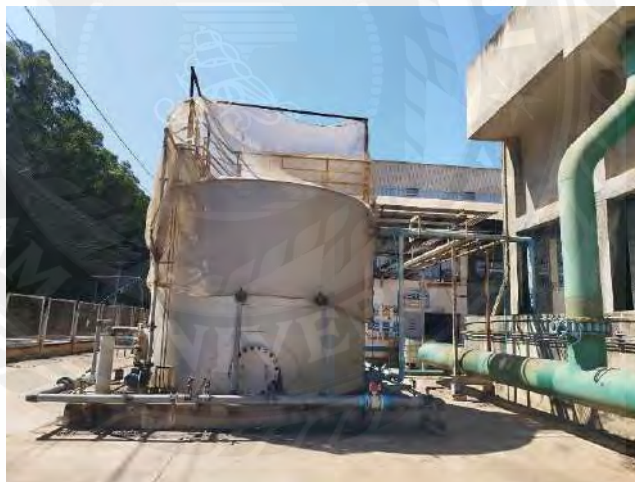
รูปภาคผนวกที่ ข.6 Corrosion Inhibitor Tank
