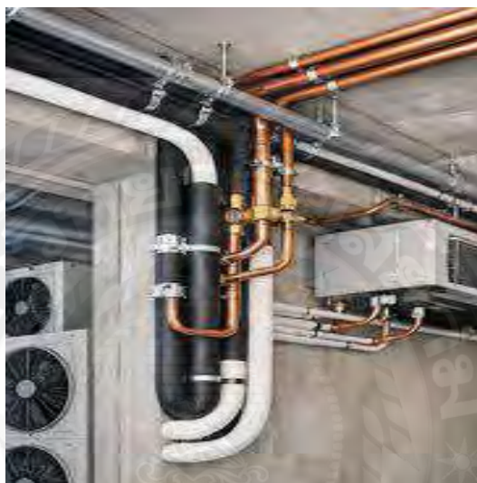
รูปที่ 3.16 ท่อสารทำความเย็น (Refrigerant Piping)
