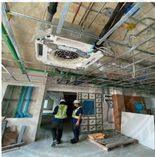
รูปที่ 3.8 การตรวจสอบเครื่องปรับอากาศให้ตรงกับตำแหน่ง
