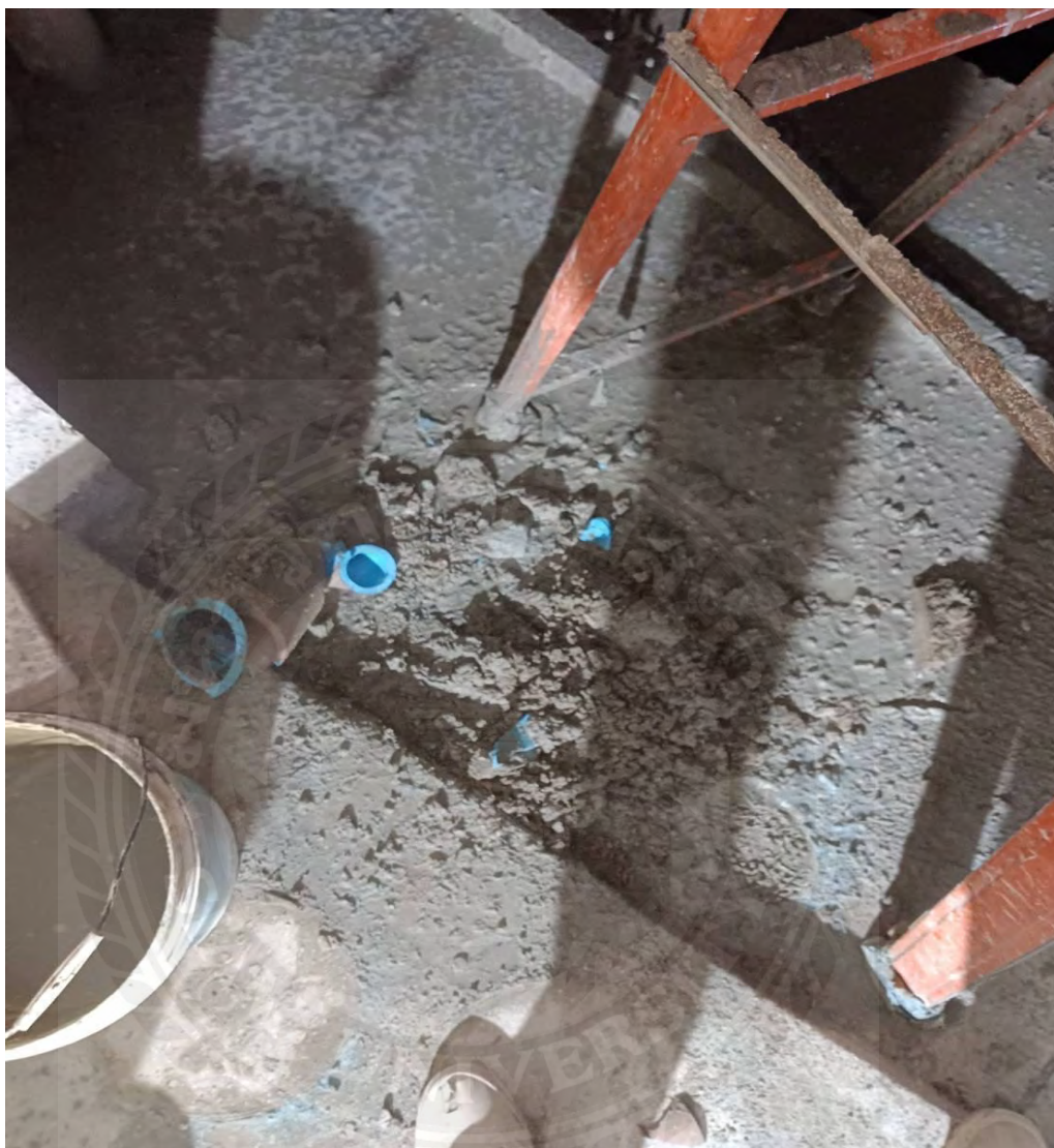
รูปที่ 3.18 เศษปูนที่อุดตันภายในท่อน้ำทิ้ง
