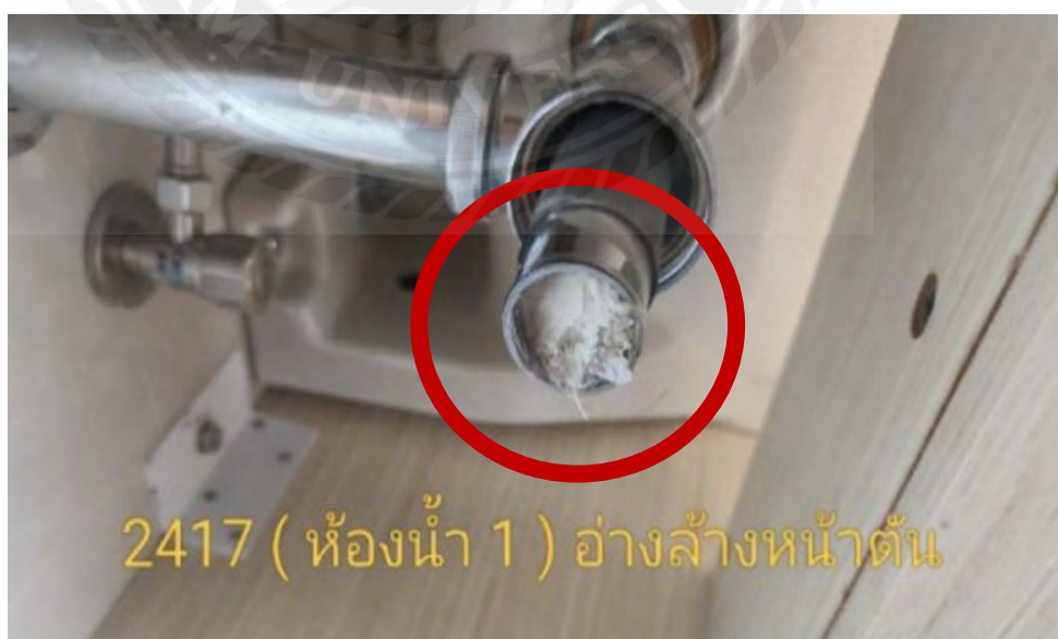
รูปที่ 3.24 การอุดตันภายในท่อน้ำทิ้งอ่างล้างหน้า
