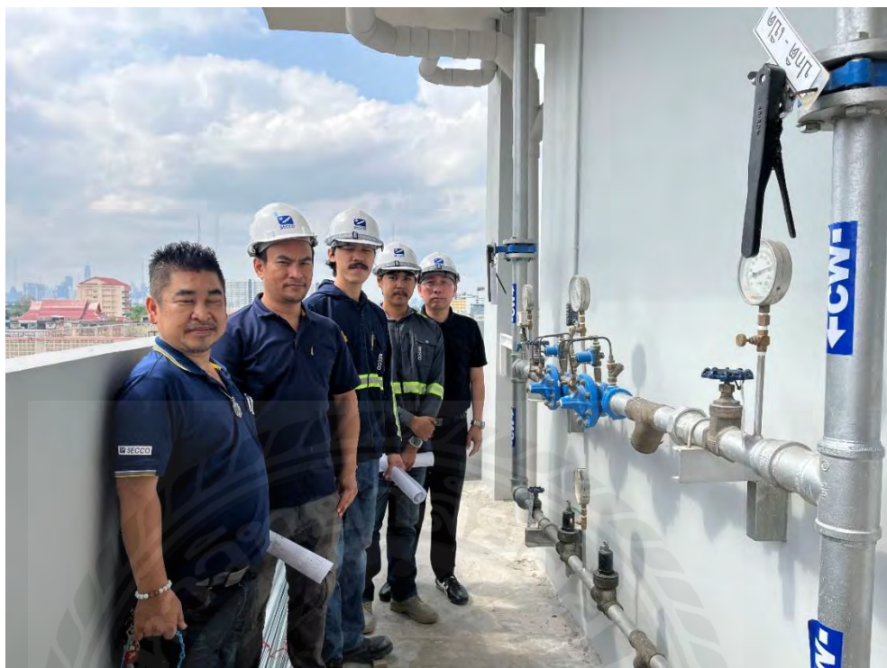
รูปที่ 3 นักศึกษาผู้ร่วมและอาจารย์นิเทศถ่ายภาพกับปั๊มที่ใช้ภายในอาคารในสถานที่ปฏิบัติงาน
