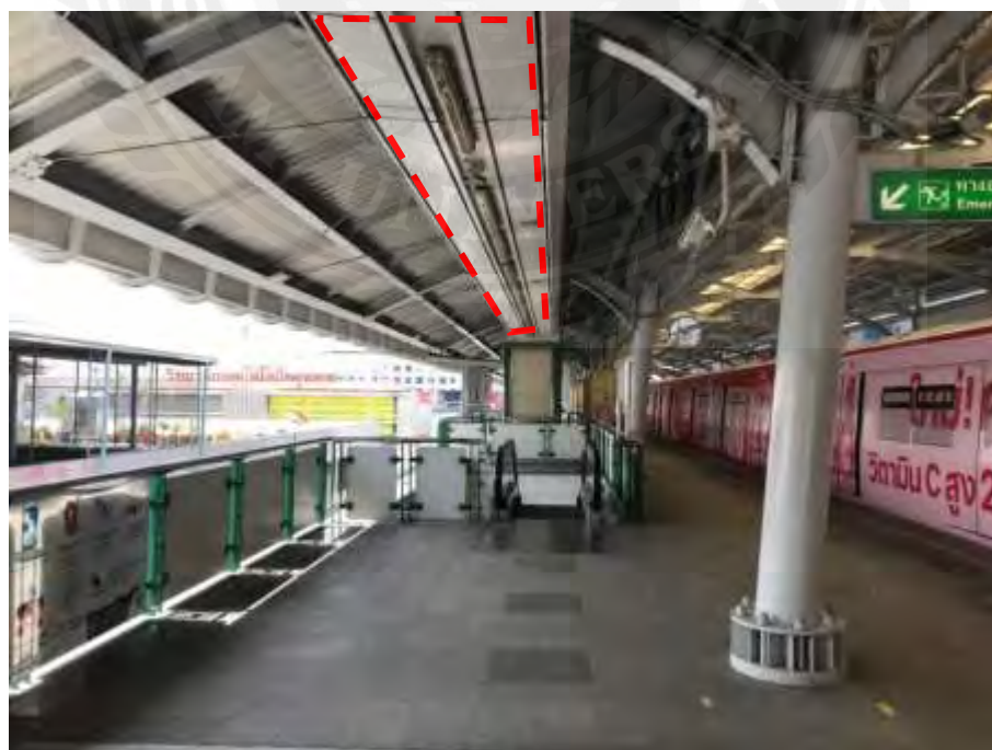
ภาพที่ 3.8 ตำแหน่งติดตั้งหลอดไฟชั้นชานชาลาของสถานีรถไฟ
