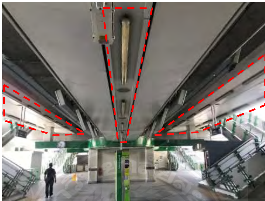
ภาพที่ 3.9 ตำแหน่งติดตั้งหลอดไฟชั้นจำหน่ายตั๋วโดยสารของสถานีรถไฟฟ้า
