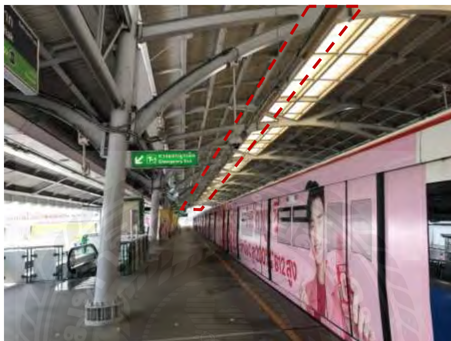
ภาพที่ 3.7 ตำแหน่งติดตั้งหลอดไฟชั้นชานชาลาของสถานีรถไฟ
